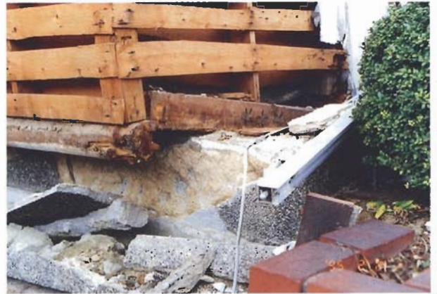
写真4.3.34 モルタル壁の剥落と部材の腐朽・蟻害 ：建物21（神戸市東灘区森南町3丁目4、住宅）
