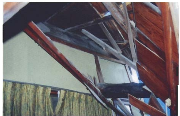
写真4.2.11 同上の内部。小屋梁(落下している丸太が見える)と桁の接合はありつき、金具はない。
