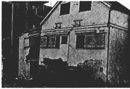
写真11 1階が倒壊した3階建て木造住宅。3階部分は、増築と考えられる(東灘区)
