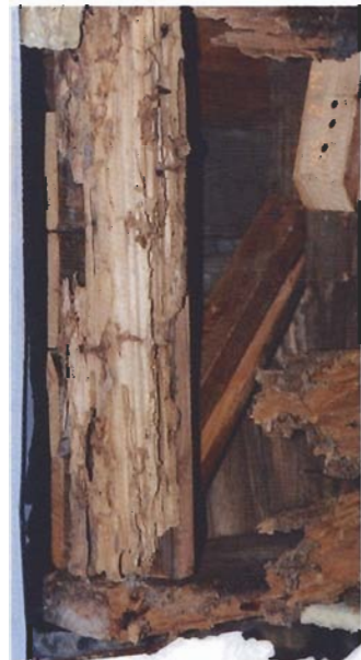
写真4.3.35 モルタル壁の剥落と部材の腐朽・蟻害 ：建物22（神戸市東灘区森南町3丁目4、住宅）
