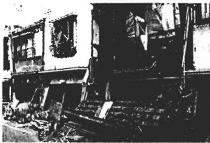
写真16 店舗併用住宅の被害。1階が大きく傾いている(長田区)
