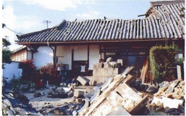
写真4.2.69 古い寺院。屋根陥没(伊丹市寺本)。材は腐朽・蟻害が著しい。
