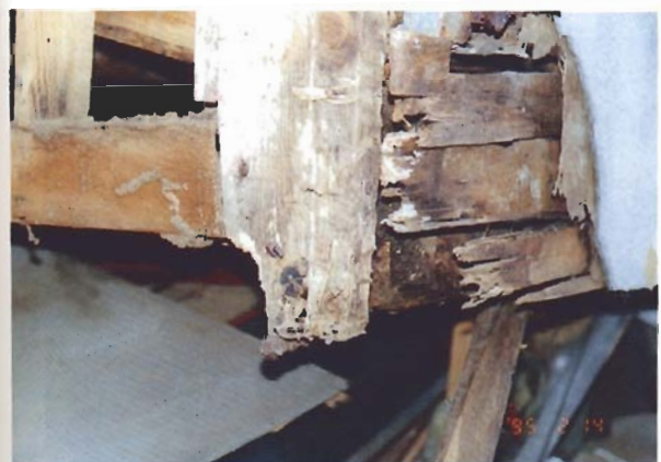
写真4.3.38 モルタル壁の剥落と部材の腐朽・蟻害 : 建物27 (神戸市東灘区本山中町1丁目12、住宅)
