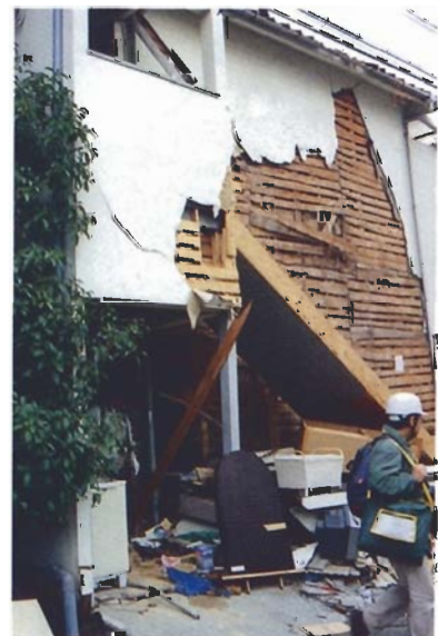
写真4.2.29 同上。危険物件指定。土台シロアリ被害。スギ90mm角、MC14~16、Pe12~18、 \phi 280/1000。妻壁に筋かいはあるが、厚さ27mmで折損。入り口横の独立柱（ヒノキ）に鉄骨補強あり。シロアリ被害Pe40。
