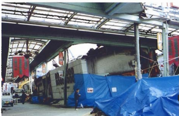
写真4.2.64 商店街の状況（西宮市中央通り商店街）。木造のみならず鉄骨系でも1階部分の壁がないためほぼ全壊し、2階のみが残っている例がほとんどである。終戦直後から営業が続いている店舗が多い。
