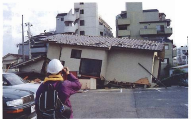
写真4.2.19 同上。建築年代は比較的新しい。2階床梁ベイツガ、105×140mm、破損なし、MC12、Pe12。通し柱ベイツガ、105mm角、健全、MC14。
