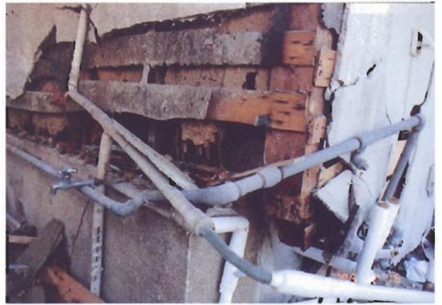
写真4.3.46 モルタル壁の剥落と部材の腐朽・蟻害 ：建物48（西宮市甲東園1丁目4、住宅）
