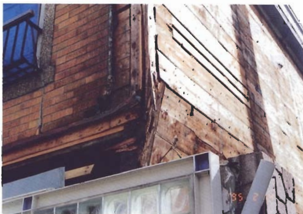
写真4.3.29 モルタル壁の剥落と部材の腐朽・蟻害 : 建物11 (芦屋市公光町1、店舗兼住宅)
