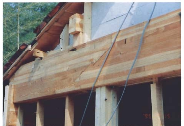
写真4.2.55 玄関棟と平屋部分の境目の横架材の架設状況。比較的スパンが短いにも拘わらず「台持ち継ぎ」により、「込栓」ではなく、この建物としては珍しく「ボルト」で接合。この辺り、設計者の意図が不明。
