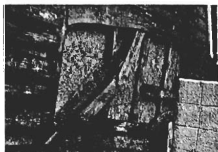
写真1 座屈した三割筋違い
