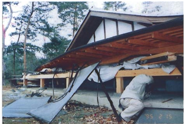
写真4.2.50 南面側から見た倒壊状態。大屋根がそのままの形で縁側に落下しており、束からはずれている束は一切見られない。手前に散乱しているのはアルミサッシの網戸である。
