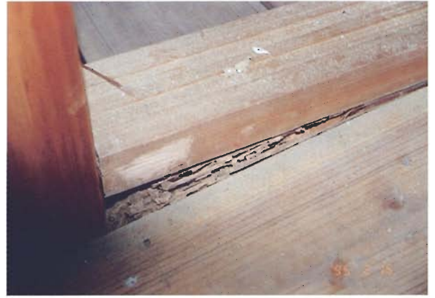
写真4.3.22 同建物の床組部材の蟻害。大引・柱・敷居には蟻害がかなり認められた。
