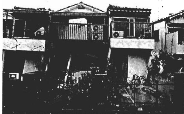
写真2 建て売り住宅の被害。間口に壁がないと被害を免れない
