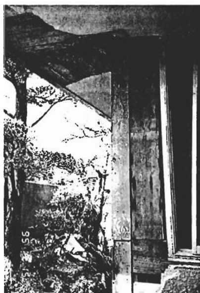
写真-6 雨仕舞の欠陥が原因で発生した腐朽の例3 バルコニーの軒裏の腐朽である。雨仕舞の悪さがもと で供給された水分が乾かずに腐朽に及んだ。この例は 数多くみられた。
