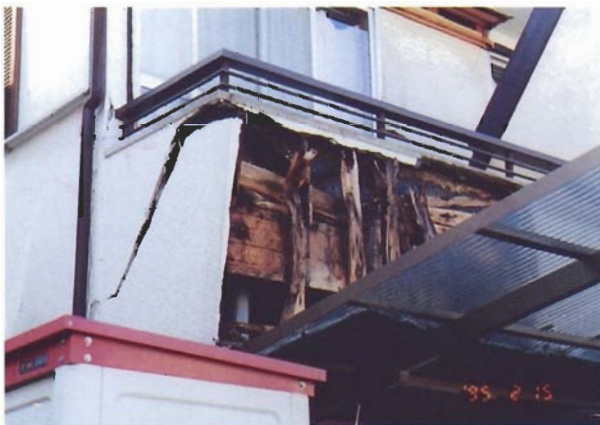
写真4.3.45 モルタル壁の剥落と部材の腐朽・蟻害 ：建物44（西宮市仁川町3丁目11、住宅）
