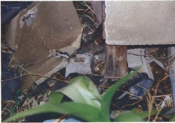
写真4.3.13 独立基礎からの柱の落下：建物23（神戸市東灘区森南町3丁目3）。瓦がすべて落下、建物が基礎からずれ。増築部分は、独立基礎（コンクリート）から柱が抜け出している。
