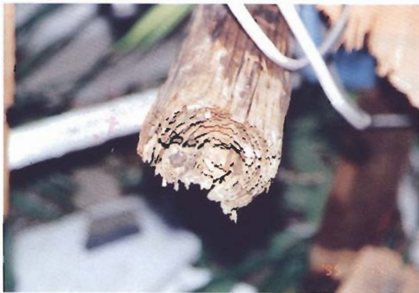
写真4.3.25 モルタル壁の剥落と部材の腐朽・蟻害 : 建物6 (芦屋市茶屋之町6、住宅)
