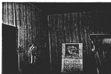
写真19 内装ボードの被害(東灘区)
