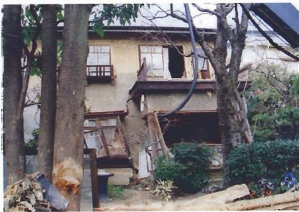
写真4.3.9 傾斜した外真壁・内大壁式住宅：建物5（芦屋市茶屋之町2）。基礎は布石式。写真は南面で、建物は西側へ約50cm移動し、北へ傾斜。
