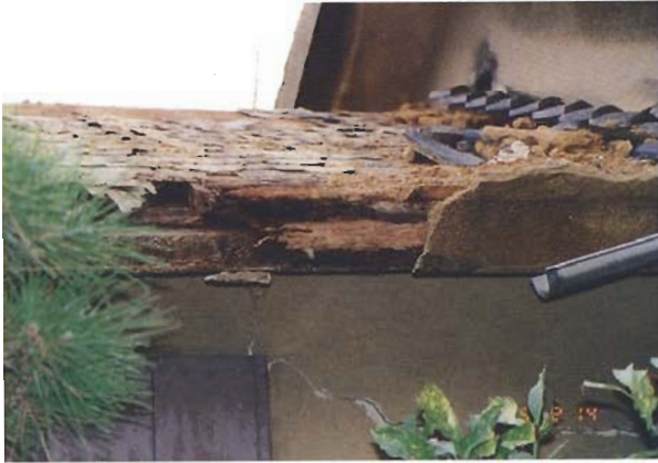
写真4.3.14 同建物の屋根軒先部の腐朽。軒先はモルタル様のもので包んでいるが、水分滞留のため内部は激しく腐朽し、シロアリ食害も認められた。
