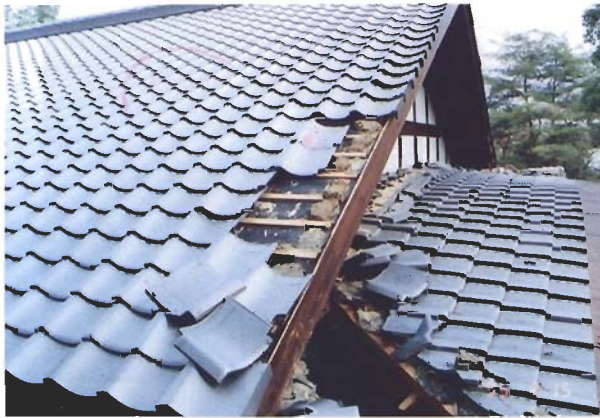
写真4.2.51 屋根の被害状況。瓦は瓦棧に釘2本で止め付けるタイプで、瓦の脱落はほとんどなかった。また、葺土が併用されているのが見える。
