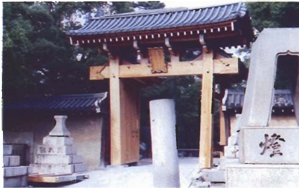
写真4.2.72 No.5一戎神社裏門の柱のずれ。材はヒノキ。測定時の \theta は15/1000であったが、地震直後はこのような状況であった（本写真は東洋大学秋山氏の提供による）
