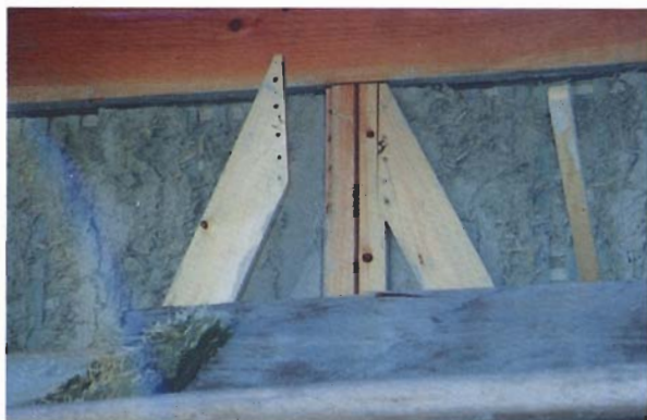
写真4.2.61 同上壁筋かい上部。厚さ24mm、釘N65くらい、5本打ち（抜けている）、柱に切り欠き。この筋かいは、ほとんど効いていないように思える。柱材はヒノキ。
