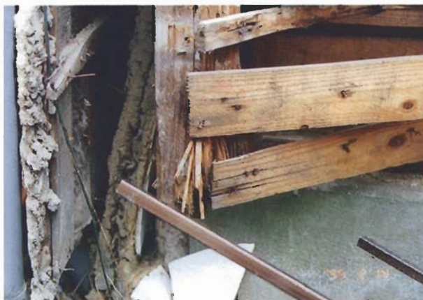
写真4.3.33 モルタル壁の剥落と部材の腐朽・蟻害 ：建物19（神戸市東灘区森南町2丁目10、住宅）
