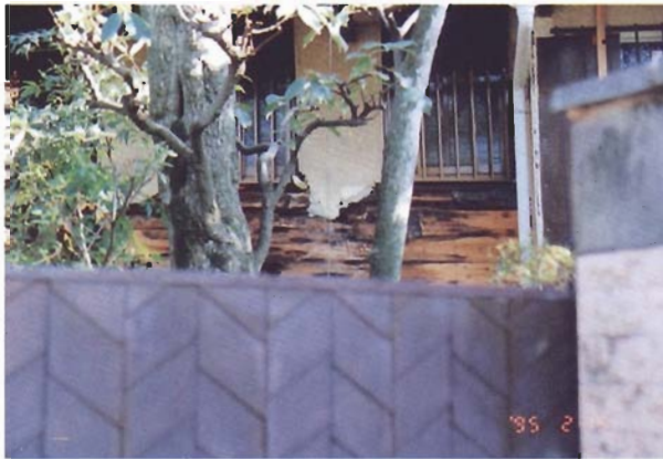
写真4.3.44 モルタル壁の剥落と部材の腐朽・蟻害 ：建物43（西宮市仁川町3丁目14、住宅）
