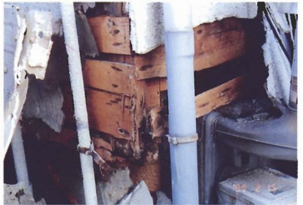
写真4.3.47 モルタル壁の剥落と部材の腐朽・蟻害 ：建物50（西宮市上田市1丁目3、住宅）
