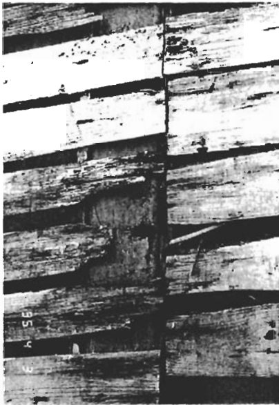
写真-7 結露水が原因で発生した腐朽の例 鋼材に接した木摺下地の腐朽で、結露が原因であると思われる。
