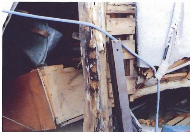
写真4.3.28 モルタル壁の剥落と部材の腐朽・蟻害 : 建物10 (芦屋市公光町2、店舗兼住宅)
