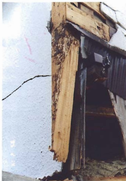
写真4.3.40 モルタル壁の剥落と部材の腐朽・蟻害 : 建物32 (神戸市東灘区本山中町2丁目7、住宅)
