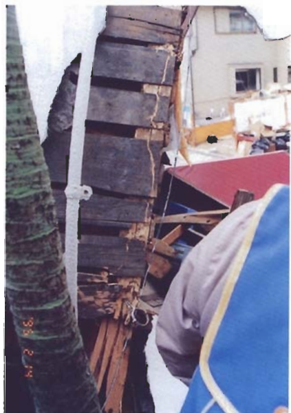
写真4.3.26 モルタル壁の剥落と部材の腐朽・蟻害 : 建物7 (芦屋市茶屋之町4、住宅)
