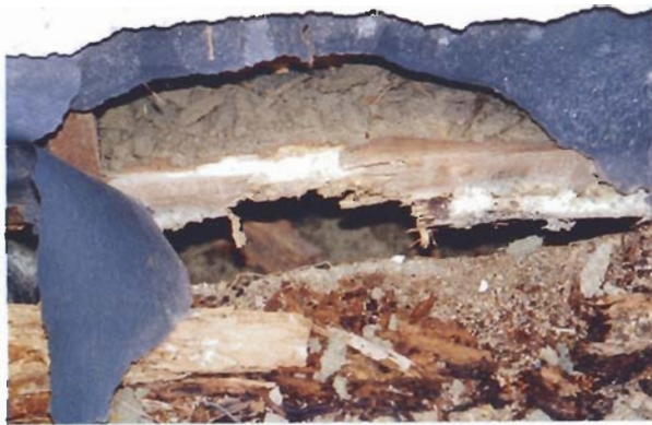
写真4.3.8 同建物敷地内物置の土台。腐朽と蟻害によりその機能がほとんど失われている。土台と基礎を緊結するアンカーボルトも激しく腐蝕しており 各所で切断。
