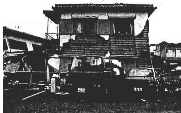
写真8 モルタルの剥落。
