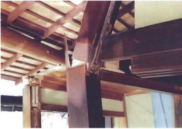
写真4.3.19 同建物の柱と横架材の損傷
