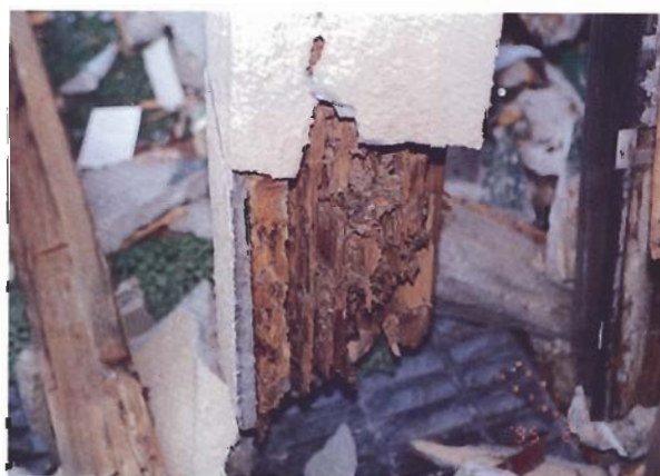
写真4.3.30 モルタル壁の剥落と部材の腐朽・蟻害 : 建物13 (芦屋市川西町3、住宅)
