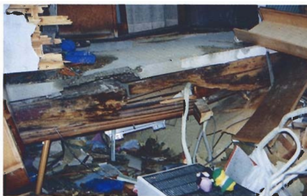
写真4.2.27 同上の2階床。直下は1階床である。床梁は腐朽・蟻害。
