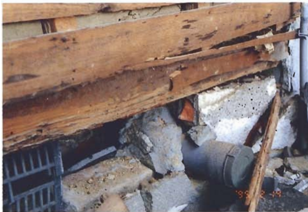
写真4.3.31 モルタル壁の剥落と部材の腐朽・蟻害 ：建物15（芦屋市津知町8、住宅）
