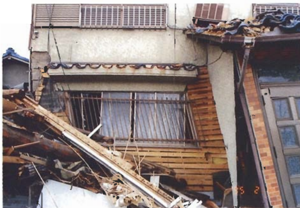
写真4.3.32 モルタル壁の剥落と部材の腐朽・蟻害 ：建物16（芦屋市津知町2、住宅）
