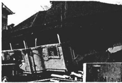
写真10 1階が倒壊した新しい住宅。1階部分がガレージで耐力壁が偏って配置されていた(灘区)
