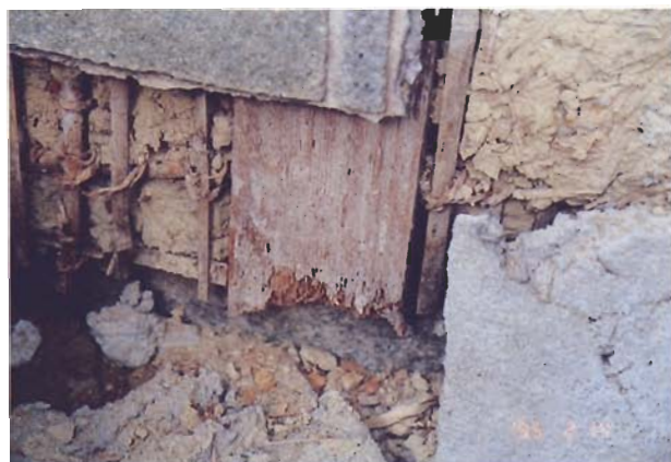
写真4.3.2 同建物の洋間に隣接する玄関壁内柱の腐朽。洋風部に隣接した玄関部分の土台なし。柱は基礎からはずれ、柱下部は内部まで著しい腐朽。
