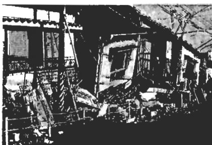
写真8 1階が軒並み倒壊した木造住宅(兵庫区)
