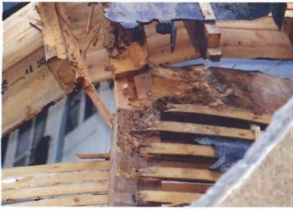
写真4.3.7 同建物の医院待合室大壁内部木材の腐朽と蟻害。待合室の張り出し部の外壁剥離、下地露出。柱（ヒノキ）の基部から上部まで腐朽と蟻害（ヤマトシロアリによる）が著しい。
