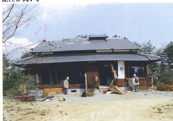
写真4.3.18 伝統工法民家の損傷：建物39（宝塚市塔の町・S女子学院内）。小松班のNo.30と同じ建物。腐朽、蟻害は認められなかった。
