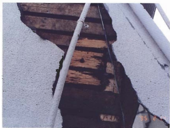
写真4.3.27 モルタル壁の剥落と部材の腐朽・蟻害 : 建物8 (芦屋市大槻町5、住宅)
