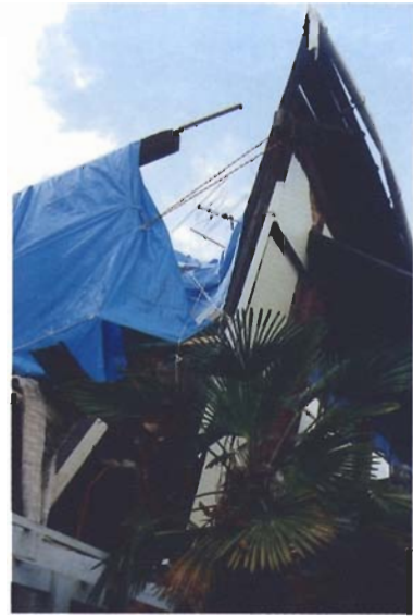
写真4.2.10 No.17-2階梁の落下した築72年の住宅(芦屋市西芦屋町)。シートが架かっているのが妻側の梁。手前に飛び出しているのが軒下の壁。隅柱と梁の接合部がはずれ、小屋梁が落下したと思われる。
