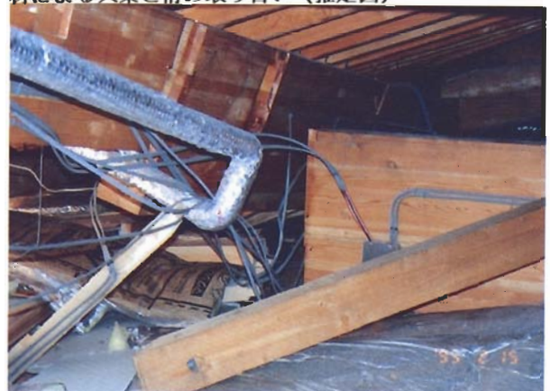
写真4.2.44 桁からの大梁の抜け落ち。大入れ深さ 約15mm程度、蟻の深さ25mm、集成材本体には全く損傷 なし。後方に丸太梁が集成材の桁に兜蟻的な様式で載 っているのが見える。火打ち梁固定のラグスクリュー (M12、1本)は完全に引き抜け。
