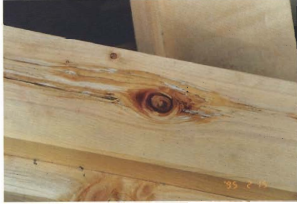
写真4.3.17 同建物の一部の部材に認められた腐朽。生立木の時、枝から樹幹に侵入した腐朽菌が活動を続けていたものと思われ、乾燥不良のまま建築された可能性が高い。
