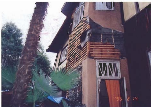
写真4.3.5 同建物医院待合室（大壁式）と上部バルコニーの崩壊
