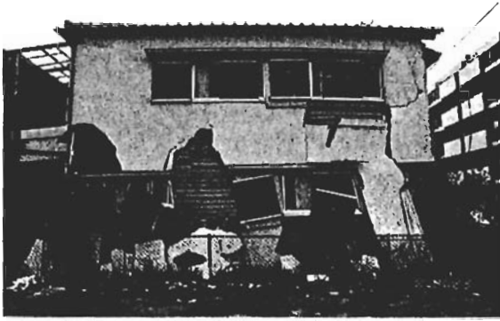
写真9 木造住宅の外装モルタルの剝落
