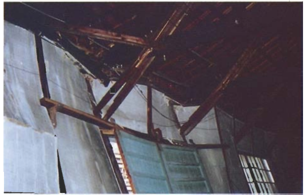
写真4.2.68 同上。トラスと柱(120mm角ヒノキ)をつなぐ方杖による柱の折損。基礎高約90cm、上の土台と柱は一応ボルトで緊結(ないところもある)。柱の完全な引き抜けなし。構造材は比較的健全、柱のMC16。
