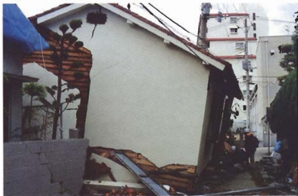
写真4.2.17 同上。2階管柱(ヒノキ?)にシロアリ被害。筋かい85×24mm、釘2本斜め打ち。近くの管柱(ヒノキ)、MC12~16、Pe11、健全。
