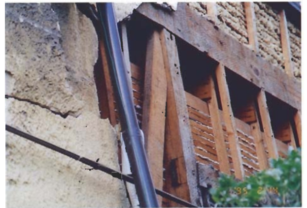
写真4.3.11 同建物東面の壁の剥落。柱や下地板が露出しているが、腐朽や蟻害は認められなかった。
