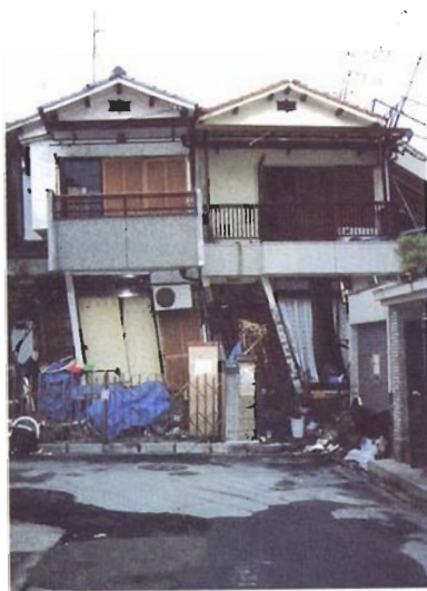
写真4.2.2 間口2間の住宅。手前の妻側には有効な耐力壁が見当たらない。（西宮市越水町）
