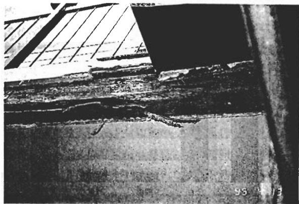
写真-5 雨仕舞の欠陥が原因で発生した腐朽の例2 アパートの廊下を支える部材の腐朽で、雨仕舞の悪さ が原因であると思われる。
