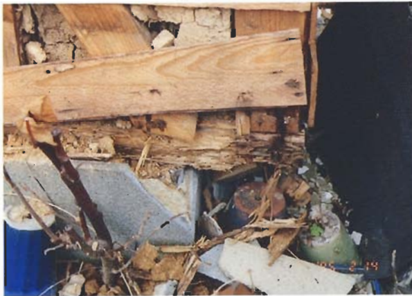
写真4.3.15 同建物の真壁内土台の腐朽と蟻害。内部まで劣化。
