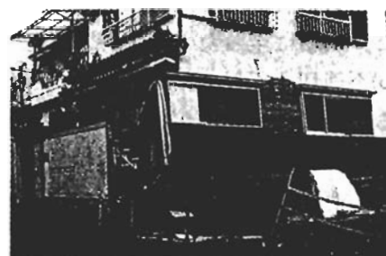
写真21 盛り土の壊崩による上部構造の被害(東灘区)
