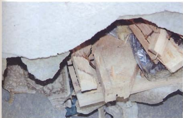
写真4.2.20 同上。壁はモルタル、L型金物使用。3つ割り筋かい、N90程度の釘2本斜め打ちであるが、端距離がなく、ほとんど効いていない。断熱材(GW)使用。
