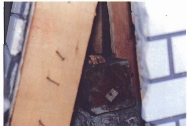
写真4.3.48 防腐剤注入土台と柱の仕口の破壊：建物12（芦屋市川西町2、住宅）。部材には腐朽・蟻害は認められなかった。しかし、土台と柱の仕口が折れ、壁が脱落して建物が傾斜していた。
