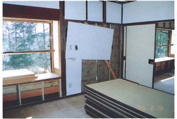
写真4.2.53 2階居室部分における耐力壁の状況。乾式ボード剥離、筋かいは三割りたすき掛け（X字型）がかすかに見える）、断熱材（GW）。内装材剥落程度、建物の変形は非常に軽く、耐力壁の威力が良く分かる。
