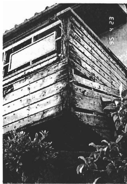
写真-4 雨仕舞の欠陥が原因で発生した腐朽の例1 バルコニーの隅角の柱と木摺下地、軒裏に腐朽がみら れる。手すりにかかる雨水が伝わったことが原因であ ると思われる。
