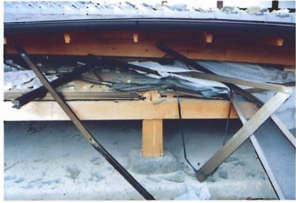
写真4.2.48 広縁外周部での柱の破壊状態。
