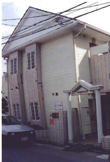
写真4.2.35 同上。外観、壁のθは90/1000。壁は乾式サイジングボード、断熱材使用、ただし材料と金具の状況から見て10年程度経過している物件(改築)か? オーバーハング部分の外壁材落下。各戸のドアは開閉不能
