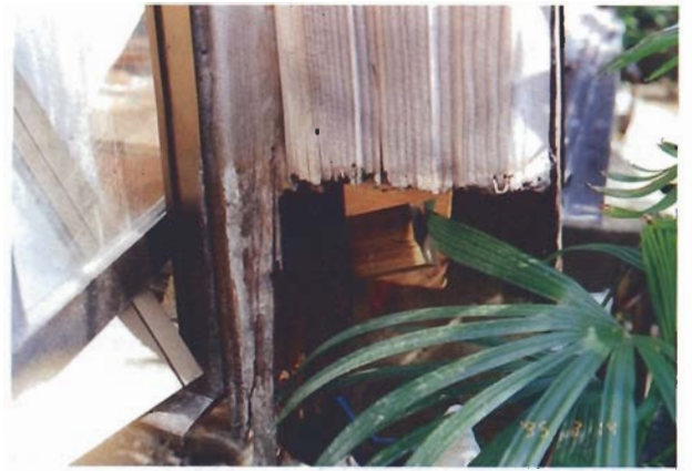
写真4.3.10 同建物の南面部柱の蟻害。柱（ヒノキ）は土台からはずれて地面に落下し、下部はヤマトシロアリに激しく食害。
