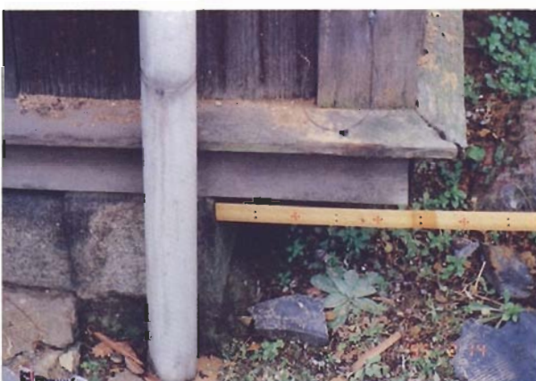
写真4.3.6 同建物の布石基礎からのずれ。基礎は建物2と同じく布石式であり、土台と基礎の緊結がないため、建物全体が25cm北側へ移動している。
