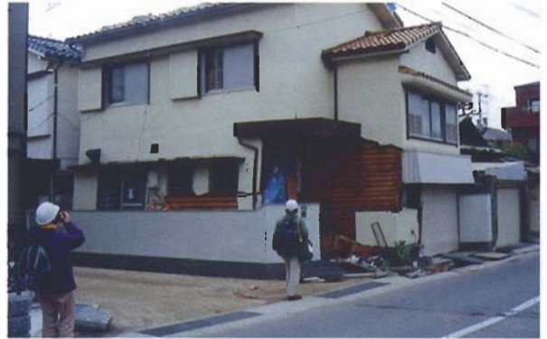
写真4.2.9 No.16-倒壊を免れた住宅(芦屋市月若町)。ガレージ開口部横の柱、ベイツガ、下側は腐れ、MC20、上部はMC14、 \phi 160/1000 。筋かいは見えない。塀で倒壊を免れた?
