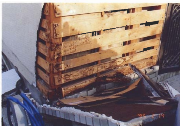
写真4.3.41 モルタル壁の剥落と部材の腐朽・蟻害 : 建物35 (神戸市東灘区本山中町2丁目12、住宅)
