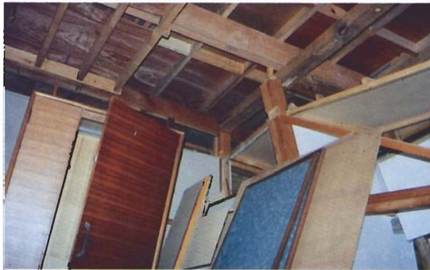
写真4.2.25 2階の内部。主要横架材同士の接合は大きな問題はないようであるが、柱類はいずれも短ほぞ、斜め釘打ち程度。桁はベイマツで95×150mm、健全、MC10~14、Pe12、グレードは低い。
