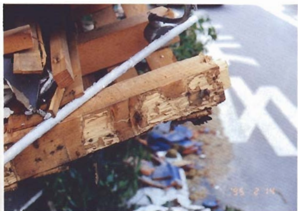
写真4.3.37 モルタル壁の剥落と部材の腐朽・蟻害 : 建物26 (神戸市東灘区本山中町1丁目14、住宅)
