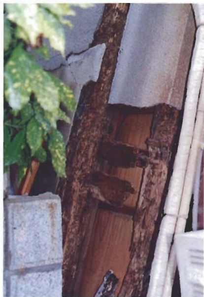
写真4.3.39 モルタル壁の剥落と部材の腐朽・蟻害 : 建物29 (神戸市東灘区本山中町1丁目1、住宅)
