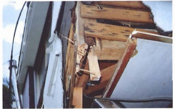
写真4.2.18 同上。通し柱の破壊状況。ベイツガ120mm角、MC14、Pe8~10、材料は健全であるが接合部が破断、羽子板ボルト・釘は若干腐食している。
