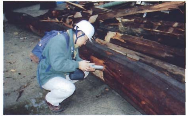
写真4.2.74 No.6一戎神社全壊構造物の梁（マツ）。Pe20~36でかなり腐朽している模様
