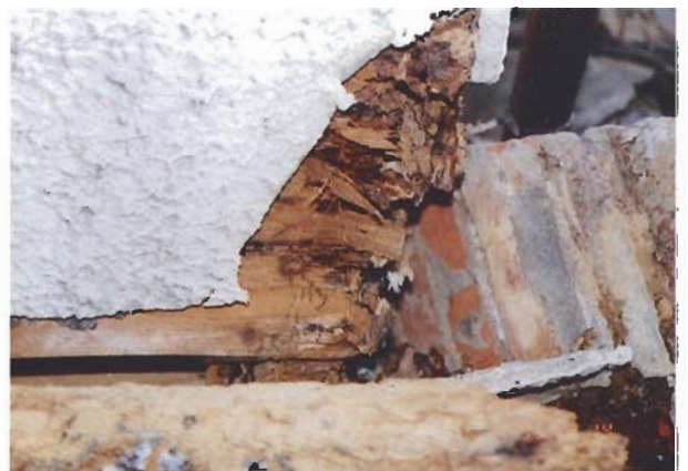
写真4.3.36 モルタル壁の剥落と部材の腐朽・蟻害 ：建物24（神戸市東灘区本山中町1丁目13、住宅）
