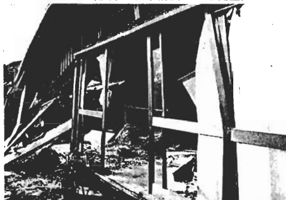
写真8 開口が大きく、耐力壁に乏しい木造住宅の被害
