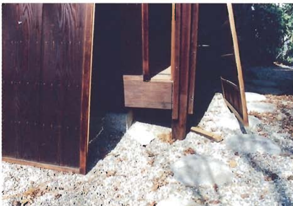
写真4.3.21 同建物柱の束石からの落下。全体が数10cm移動し、若干傾斜している。
