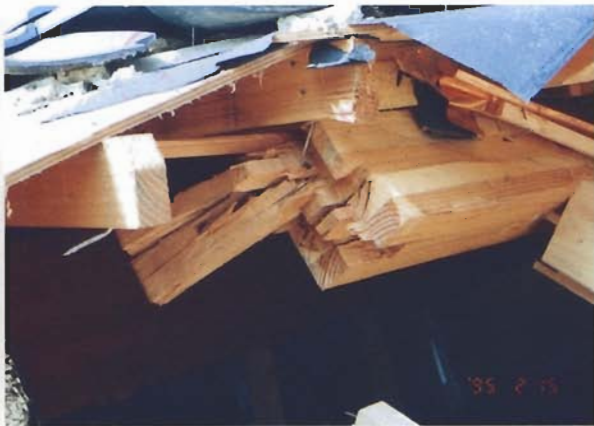
写真4.2.47 付け根から折れた桁の継手男木の部分
