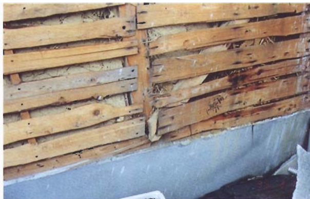
写真4.2.34 同上の壁部分。筋かい3つ割、端部は圧縮で面外に飛び出している。N90の3本打ち。柱はヒノキMC12~13、Pe8~10。
