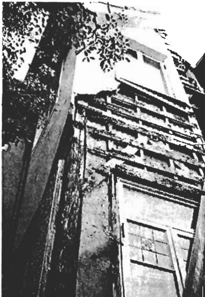
写真-1 モルタル壁内部の腐朽・ぎ(蟻)害の例1
