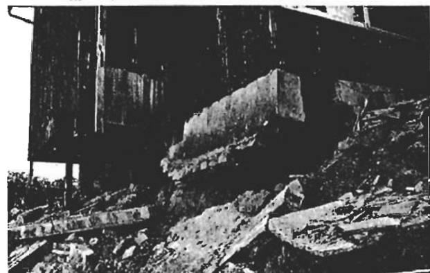
写真7 レンガ積みの基礎。地盤崩壊で露出した。
