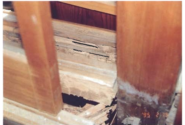
写真4.3.23 同建物床組部材の蟻害
