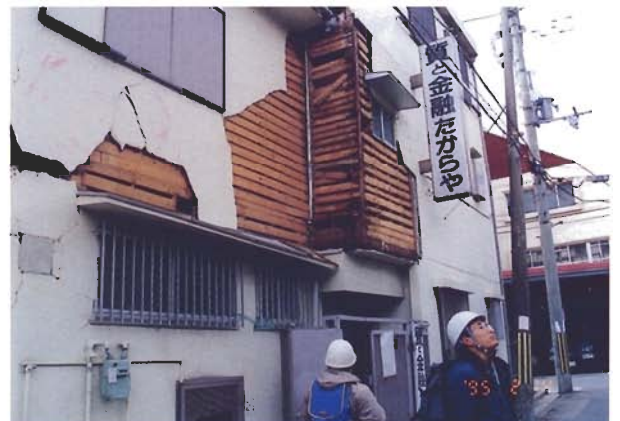
写真4.3.24 モルタル壁の剥落と部材の腐朽・蟻害：建物1（芦屋市業平町5、店舗兼住宅）
