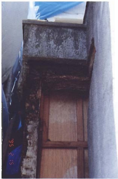
写真4.3.43 モルタル壁の剥落と部材の腐朽・蟻害 ：建物41（西宮市仁川町3丁目14、医院兼住宅）
