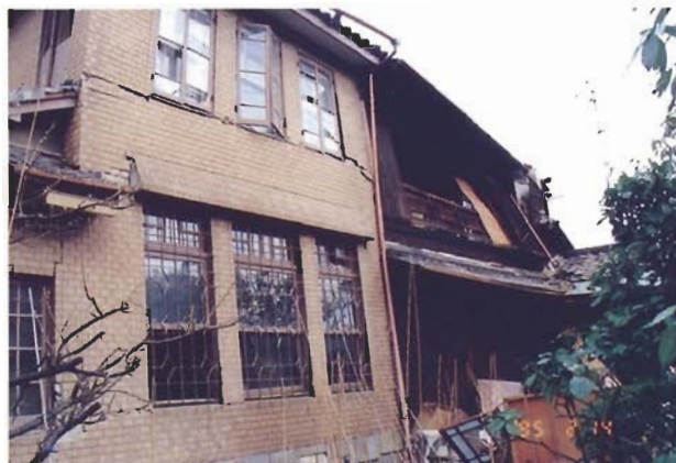
写真4.3.1 和洋折衷の真壁式住宅：建物2（芦屋市業平町5）。建物は北側に傾斜。布石式基礎、壁は真壁・土壁塗り、一部はタイル張り。床下換気はきわめて不良だったと推測される。
