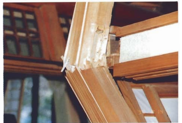
写真4.3.12 寺院書院の柱の破損：建物20（神戸市東灘区森南町2丁目9）。建築後6年で、腐朽や蟻害は全くなかったが、南に接する倒壊した戦後建築の古い建物に押されて、2本の柱（スギ）が鴨居との接合部で折れ、北へ傾いている。
