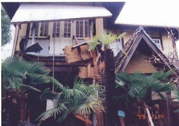
写真4.3.4 同建物の医院待合室（大壁式）と上部バルコニーの崩壊
