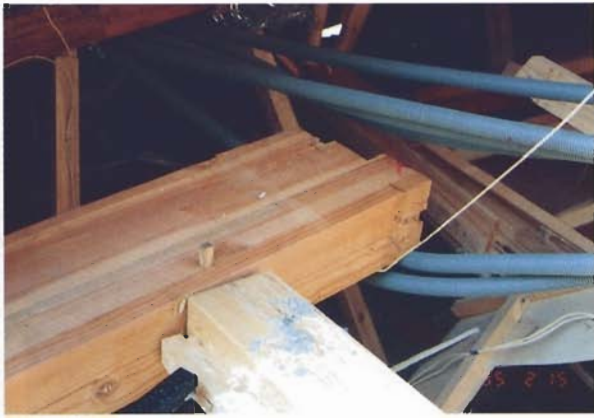
写真4.2.46 柱（ヒノキ製材、MC10～12）と桁（ベイマツ集成材）の取り合いの破損（女木側）。接合は柄差し込栓打ちで、倒壊のショックにより込栓が抜けかかっていた。
