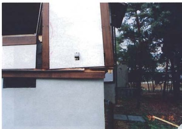
写真4.2.52 南東側コーナー部分での耐力壁の変形。耐力壁の \theta は28/1000で、化粧用の付け柱と見られる柱が土台から抜けている。構造的に大きな被害ではない。アルミサッシの窓枠が変形しているのが見える。
