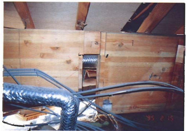
写真4.2.45 集成材桁の継手の引抜け。40畳間と18 畳間の境目辺りでせい60cmと40cmの集成材桁が柄差し 込栓打ちで接合されていた。部材は殆ど破損すること なく込栓が折れて継手は完全に引抜け。
