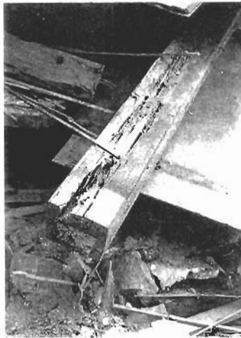
写真4 腐朽と蟻害で形を失った柱脚とほぞ(神戸市東灘区の築三十年の倒壊家屋で)
