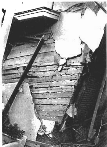
写真2 外壁モルタルと下地板が破壊され柱脚が抜けて大きく傾いた全壊家屋 (神戸市灘区で)
