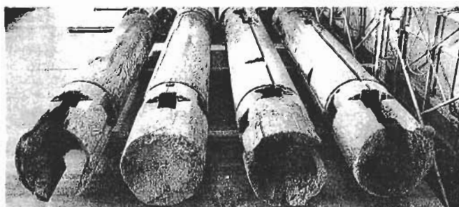
身舎柱足元の腐朽状況
