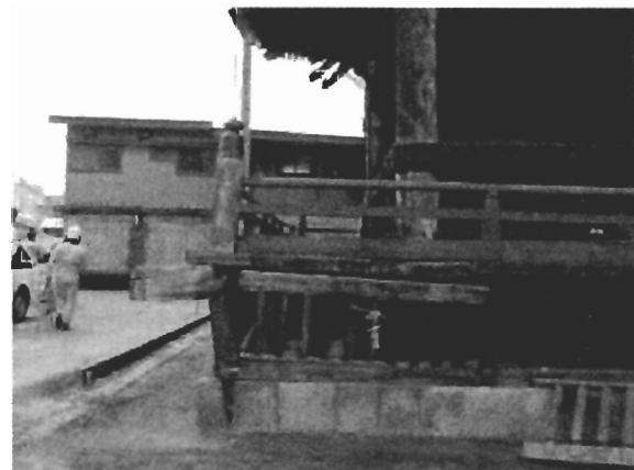
写真 19 大きく傾いた本堂
