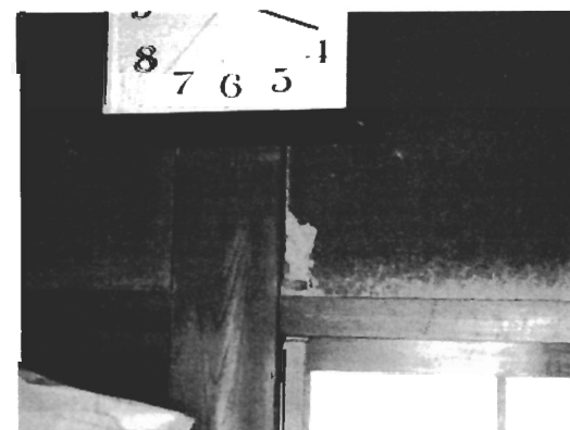
写真 11.5 土塗り壁の損傷
