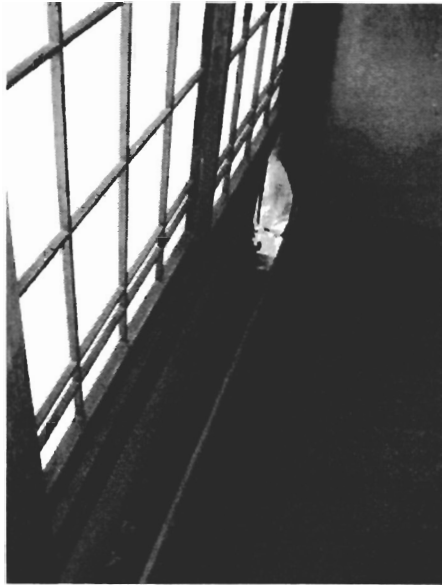
写真 8.7 南面外壁の崩壊（室内側）
