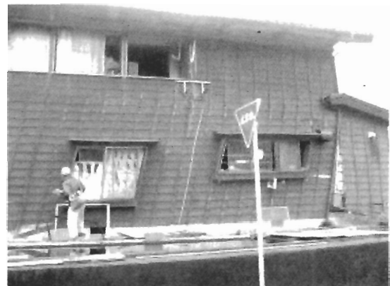
写真 2.19 1階が大変形した船柵造りの住宅
