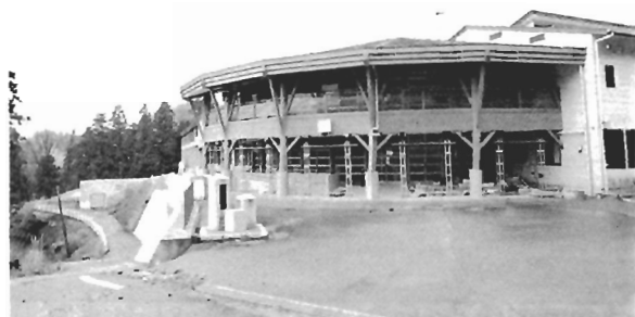
写真 N-1 小千谷市の文教施設(N)(写真正面の玄関部分の被害が目立つ)
