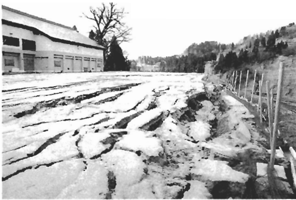
写真 N-13 建物北側のグラウンドの地割れと地崩れ(建物のすぐ近くまで地割れが生じている)
