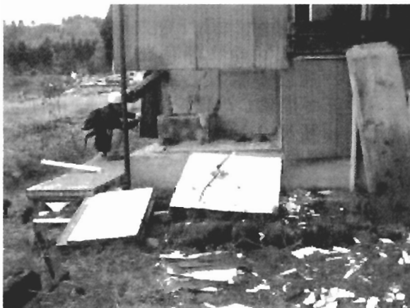
写真 2.20 コンクリート腰壁部分の局所破壊
