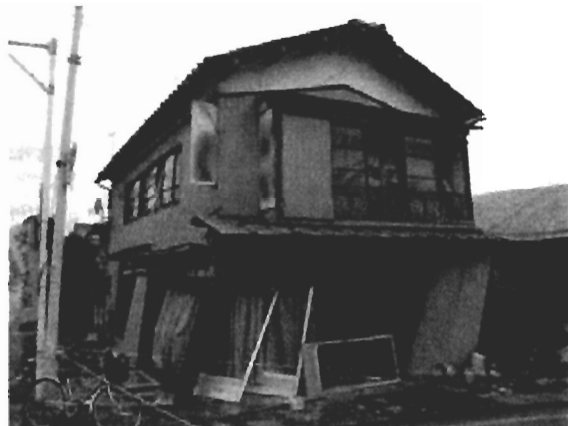
写真 24 大破した店舗併用住宅
