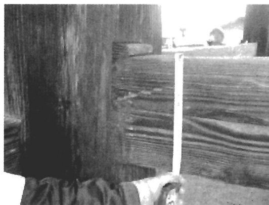
写真 2.8 弘誓寺の鐘樓の貫接合部での部材曲げ破壊。
