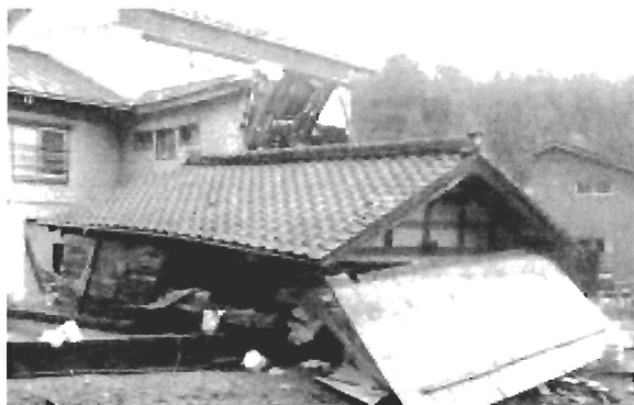
写真 2.5 全壊した小規模な船柵造りの農機具収納倉庫(推定)。
