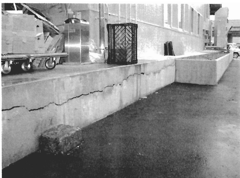
写真 U-5 建物西側犬走り部のきれつ
