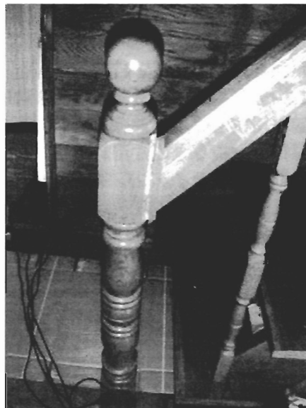
写真 12.9 階段手摺の破壊
