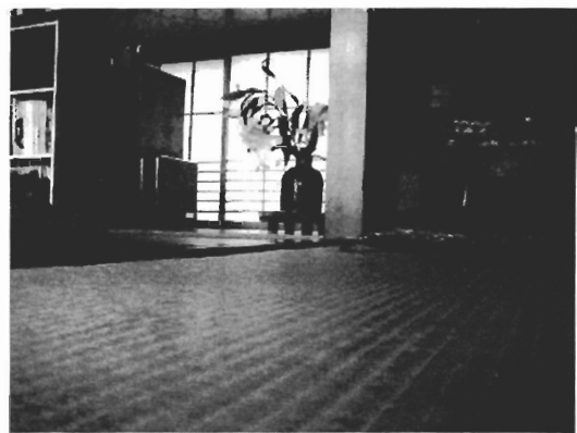
写真 12.2 1階和室に生じた段差
