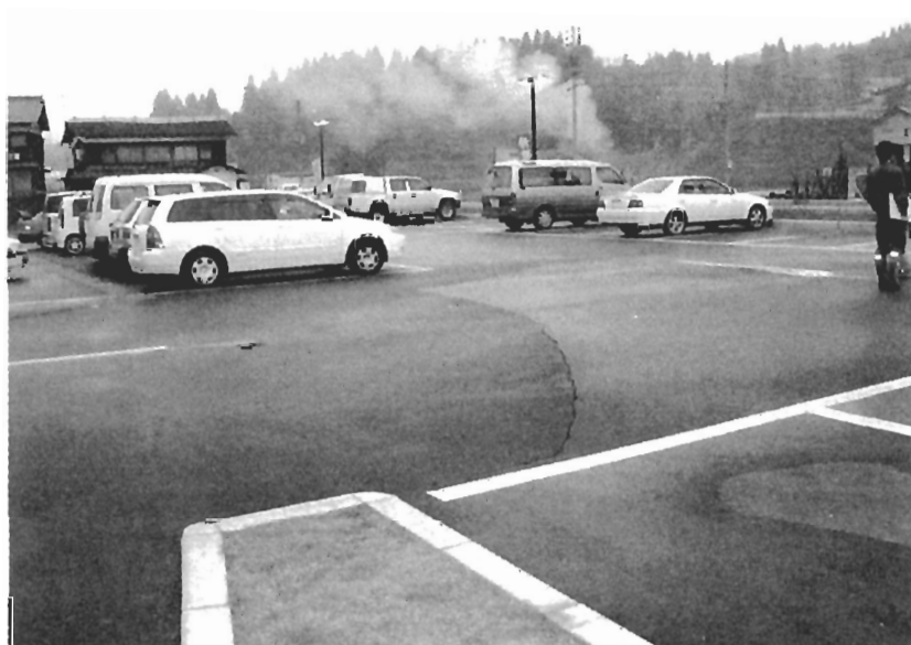
写真 U-6 店舗前駐車場(アスファルトのきれつ)
