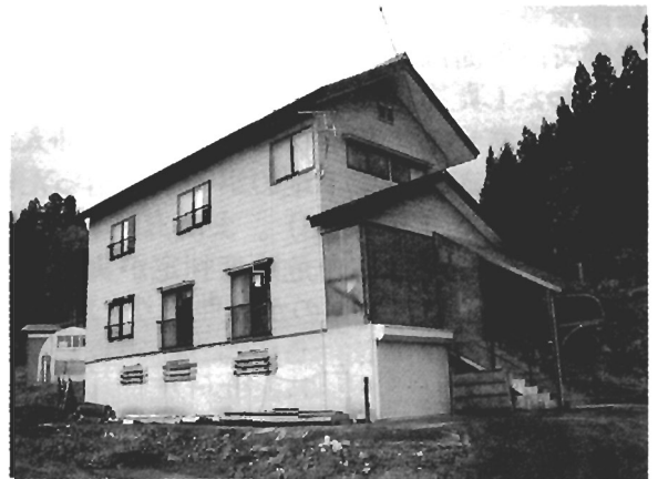
写真 F-5 近隣の住宅(要注意・基礎のひび割れ)
