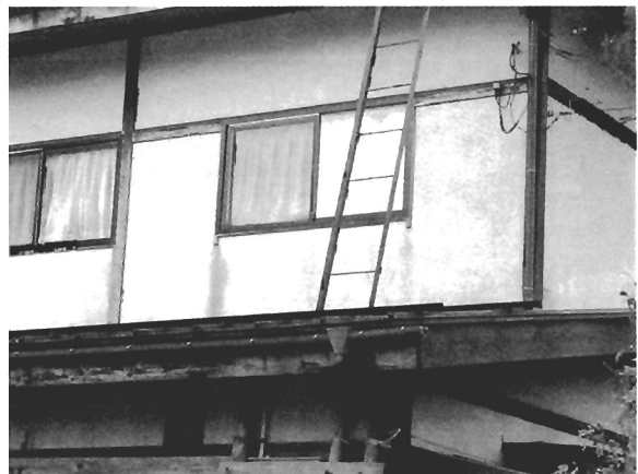
写真 D-4 近隣の住宅(外壁モルタルにきれつが生じている)
