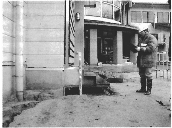
写真 N-12 南北棟西側の地盤の沈下
