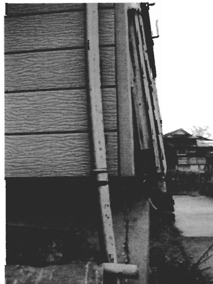
写真 8.6 南面外壁の崩壊
