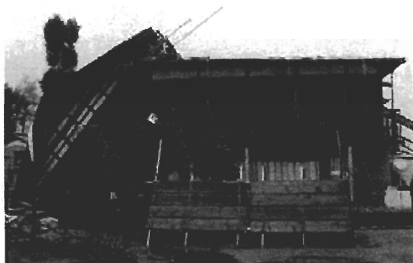
写真 22 2階が崩落した高床式木造
