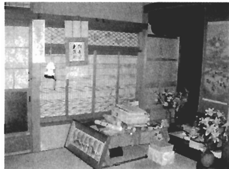
図7 No. 15 内壁の剥落、ラスボードの落下
