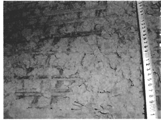
図11 剥がれ落ちた土壁
