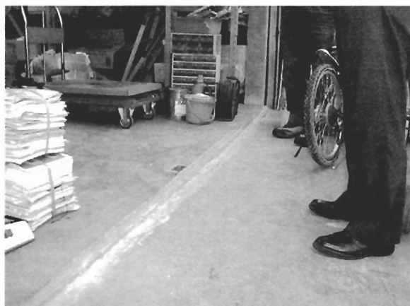
写真 Q-6 建物西側犬走り部(建物と犬走り部の間にすき間が生じた(補修済))
