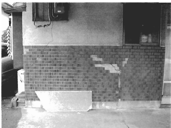
写真 Q-7 近隣の住宅(外壁のきれつ、タイルの剥落)
