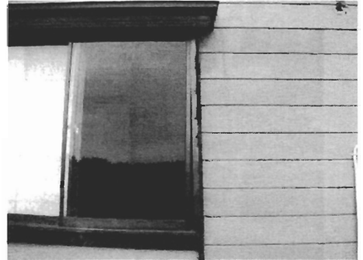
写真 8.10 1階南面の残留変形
