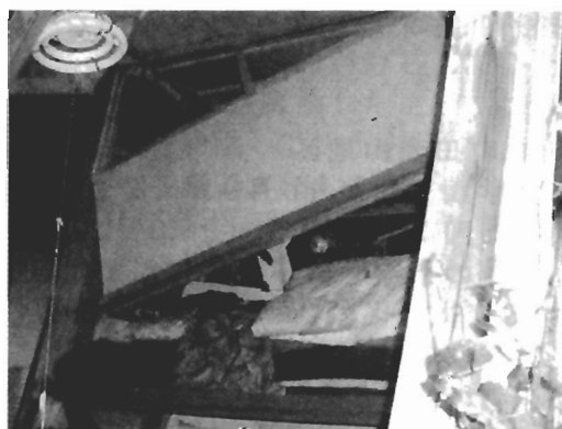
写真 2.30 小壁の落下した在来軸組構法住宅
