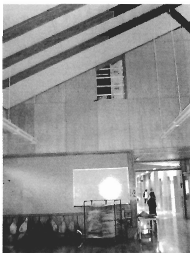
写真 S-7 教室棟・オープンスペース(内装壁の剥落)
