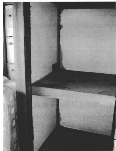
写真 12.8 押入内壁の損傷 (2階和室)
