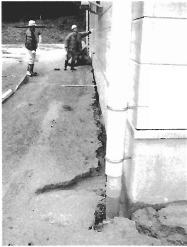
写真 N-11 南北棟北側の地盤の沈下
