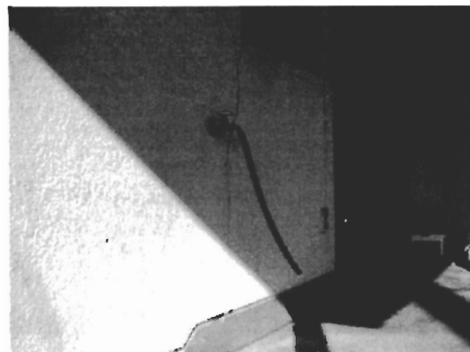
写真 11.2 構造境界部の亀裂
