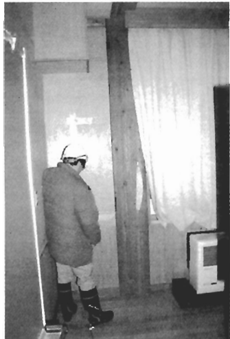
写真 N-7 南北棟 2 階教室(集成材柱の割れ)
