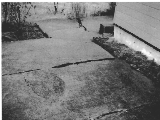
写真 8.3 地盤の割れ（東南角部）
