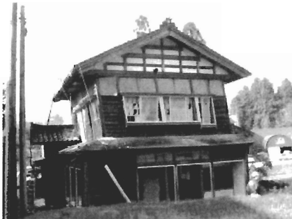
写真 2.14 2階が大きく傾いた船柵造りの住宅
