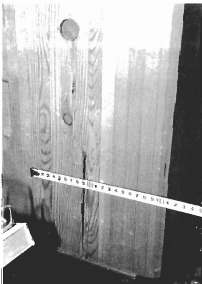
写真 P-3 集成材アーチ脚部の割れ
