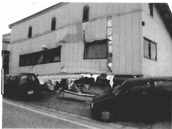
写真 2.24 1階が崩壊し、2階がその上に乗った作業所(事務所、倉庫)
