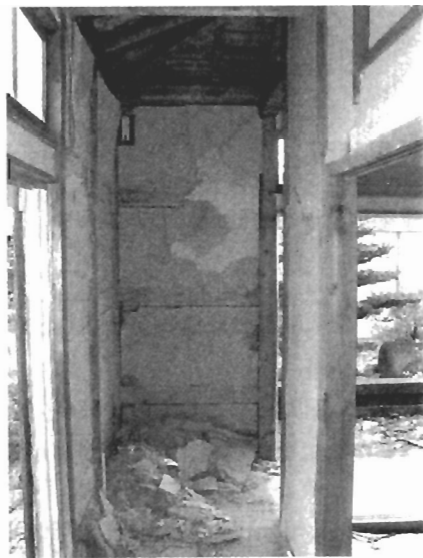
図7 貫が露出した土壁
