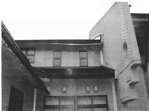
写真 S-9 特別教室棟の防火壁(アルミ製の板が変形している)
