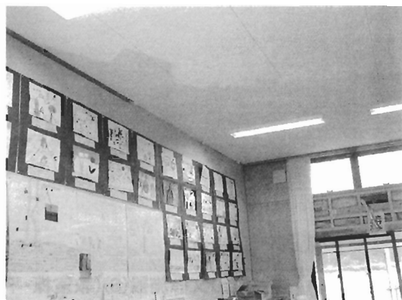
写真 S-8 教室(回縁の破壊、壁材の剥落)
