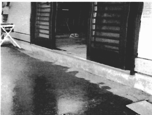
写真7.2 地盤の沈下 (地震前は段差無し)
