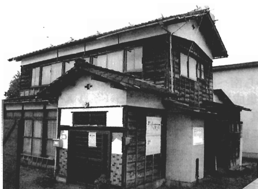
写真 U-7 近隣の住宅(屋根瓦の落下, 漆喰の剥落)
