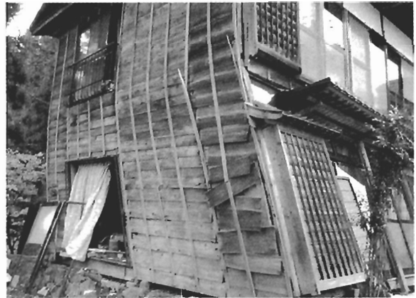
写真 N-14 近隣の住宅(1階部分が大きく傾いている)
