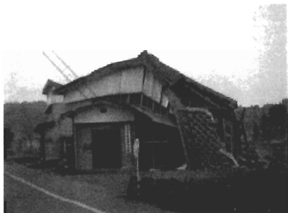
写真 21 2階が層崩壊した集会場
