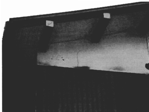
写真 9.4 モルタル外壁の亀裂
