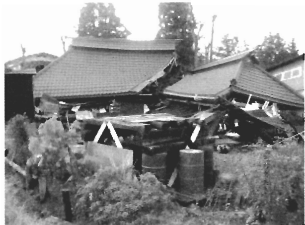
写真 2.32 全壊した新築の伝統構法住宅(屋根が途中で2つに分割されている)
