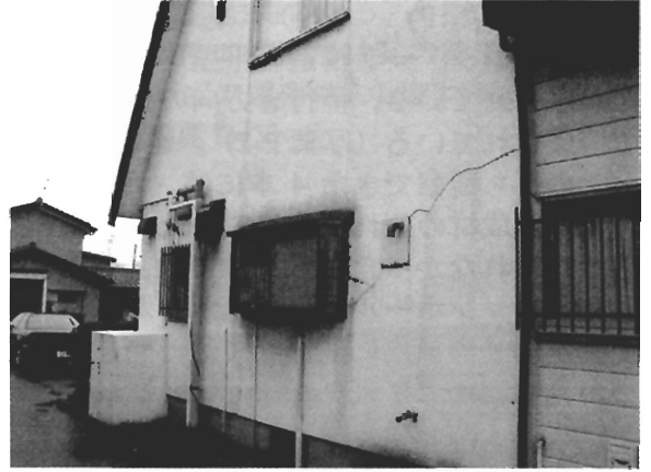
写真 P-6 近隣の住宅(モルタル外壁のきれつ)
