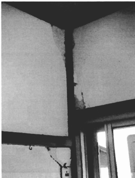
写真 12.5 1階トイレ内壁の損傷
