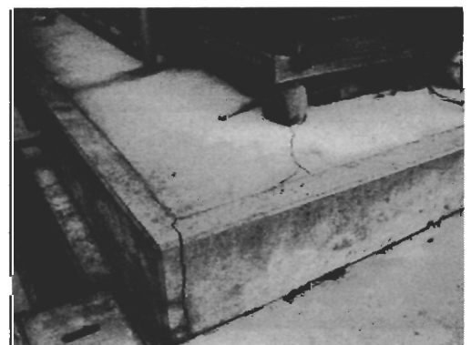
写真 10.2 基礎地盤の亀裂
