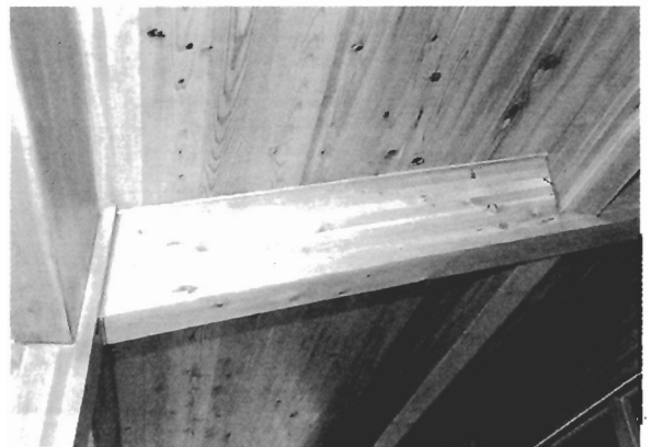
写真 E-4 集成材接合部
