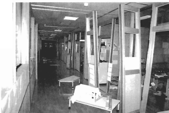
写真 N-9 東西棟 2 階廊下(可動式間仕切り壁がレールから外れている)
