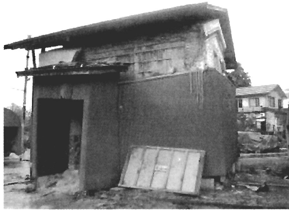
写真 2.10 田川地区におけるその他の土蔵の被害。
