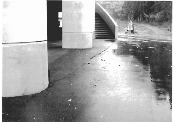
写真 S-12 同体育館(アスファルトのきれつ)
