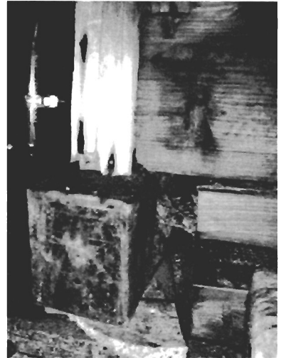
写真 6.3 土台仕口の引き抜け
