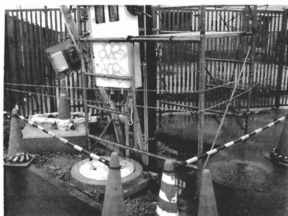
写真 O-3 隣接する電信柱（周囲の地面が陥没）
