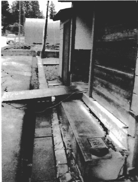
写真 8.2 地盤のずれ（玄関前）
