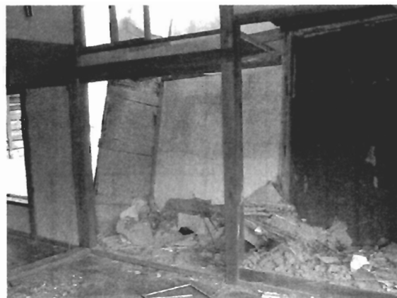
図5 床の間の土壁損傷状況
