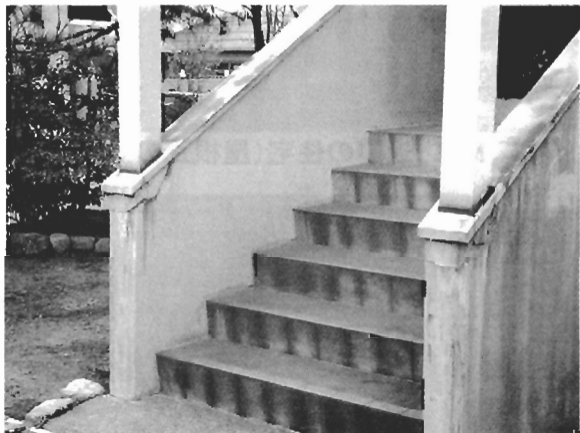
写真 L-7 近隣の住宅(玄関階段のコンクリートのきれつ、破壊)
