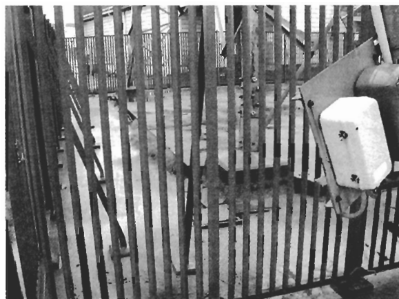
写真 O-4 隣接する送電線鉄塔（基礎の一部破壊）
