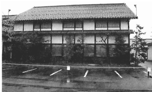
写真 O-2 隣接する店舗（屋根瓦の落下の恐れがある）
