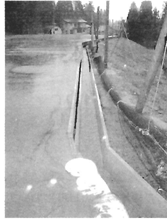
写真 Z-6 建物北西側のグランド(盛土の崩れ, 側溝のずれ, フェンス支柱の傾き)
