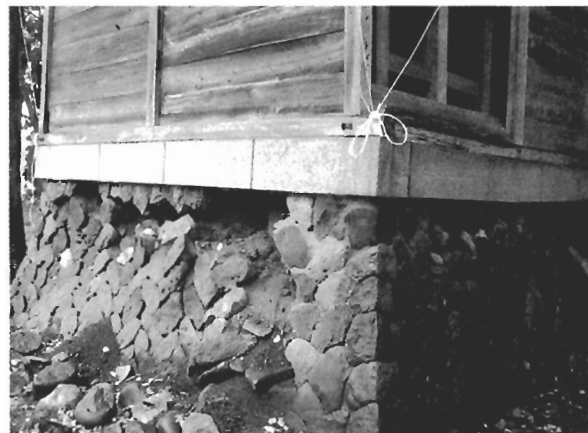
写真 S-15 近隣の神社(石垣の崩壊)
