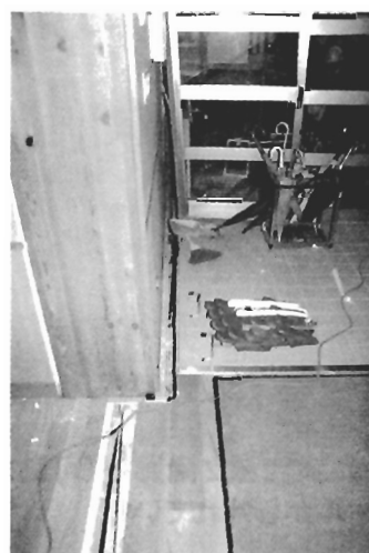
写真 N-4 玄関棟(南北棟との境の床面にすき間が生じている)
