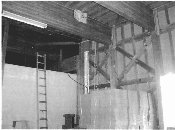
写真 X-3 製材柱と集成材梁の接合部
