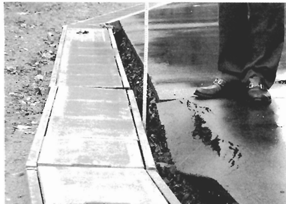
写真 S-13 敷地内の地面の陥没
