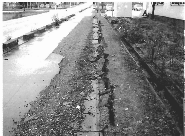
写真 S-16 近隣の地面の陥没
