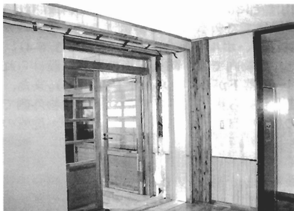
写真 S-5 特別教室棟 2 階廊下(エクspansionジョイント部のアルミ製カバーが落下し、床のレベル差も生じている)
