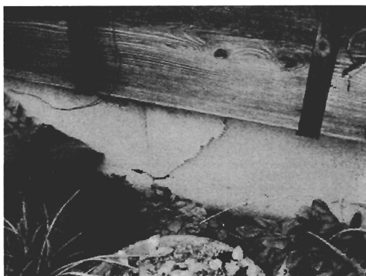
写真 5.5 布基礎のせん断破壊（東面）
