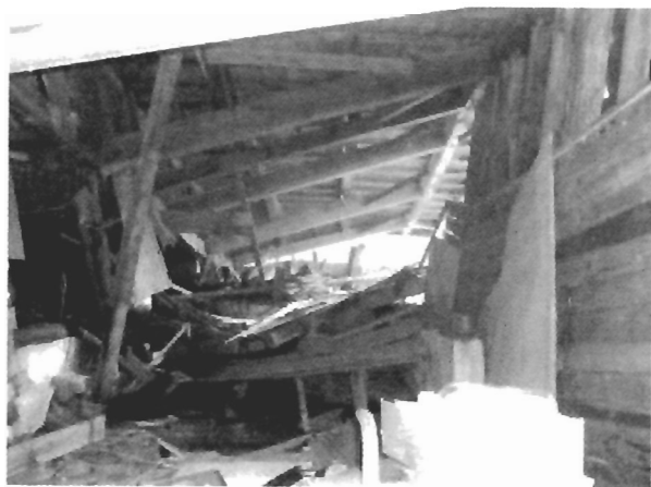
写真 2.23 作業所の屋根の崩壊
