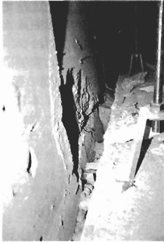
写真 N-5 玄関棟床下(布基礎のきれつ, 土間コンクリートとの間に生じたすき間)
