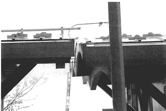
写真 C-7 屋根(隣接するトイレ棟の屋根(左)と接触し、樫が変形している)
