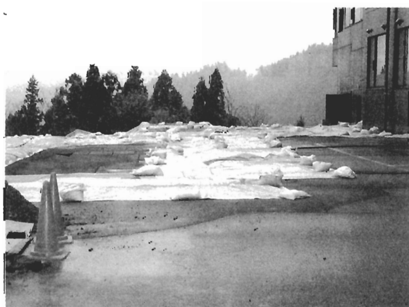
写真 V-2 隣接する建物脇の盛土の崩落
