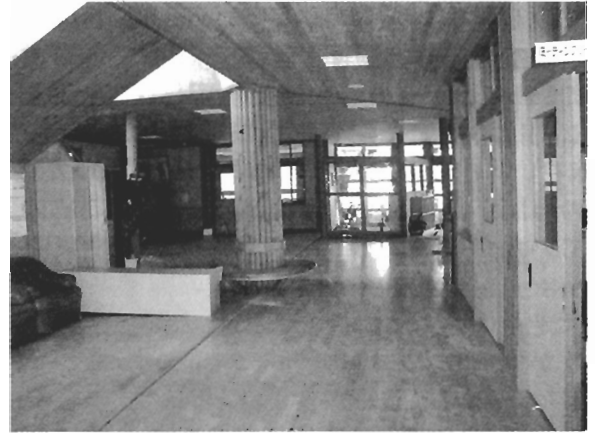
写真 N-6 玄関棟(床面のすき間)
