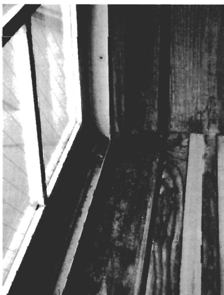
写真 13.3 西側壁面の剥離
