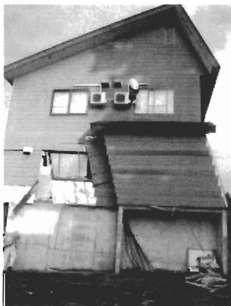
写真 2.28 RC高床式住宅の被害
