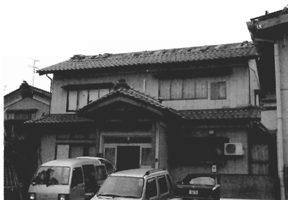
写真 M-4 近隣の住宅(屋根瓦のくずれ)
