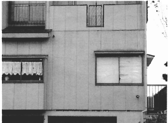
写真 L-6 近隣の住宅(モルタルのひび割れ)
