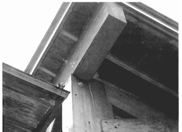
写真 J-2 柱頭(梁受け部の割れ)
