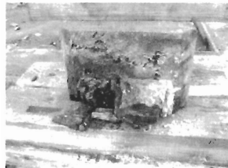
写真 2.27 鐘樓柱脚の蟻害部分
