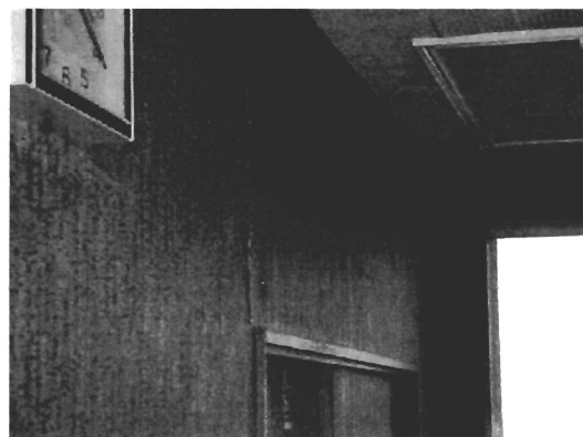
写真 13.2 内装クロスのしわ（2階廊下）
