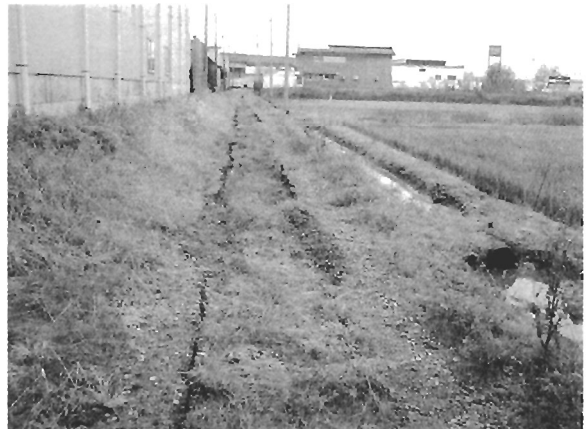
写真 J-6 工場敷地沿いの農道の地割れ(マンホールの浮き上がりも生じていた)
