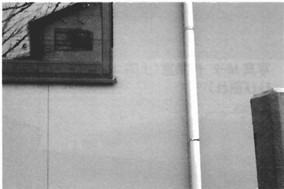
写真 L-5 外壁のモルタルのひび割れ
