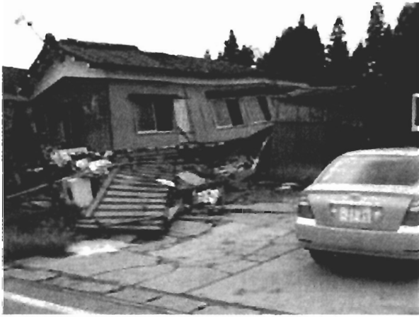
写真 27 川口町武道窪の倒壊家屋
