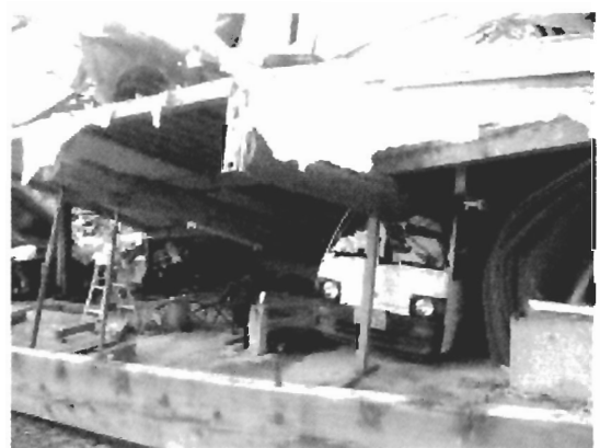
写真 2.33 全壊した在来軸組構法による工務店作業所兼事務所の建物
