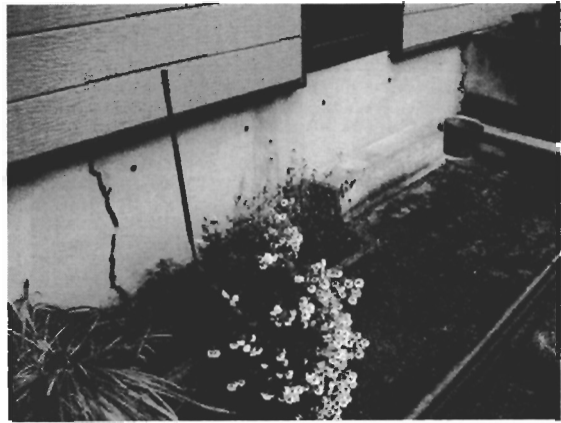
写真 8.4 基礎のせん断破壊（西面）
