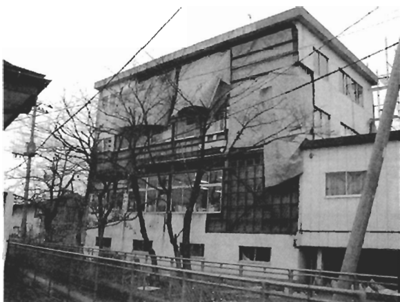
写真 M-3 隣接する鉄骨造の建物(外壁の剥落)
