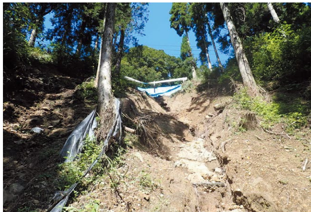
土砂流出（水害）による森林被害状況（令和7年）
