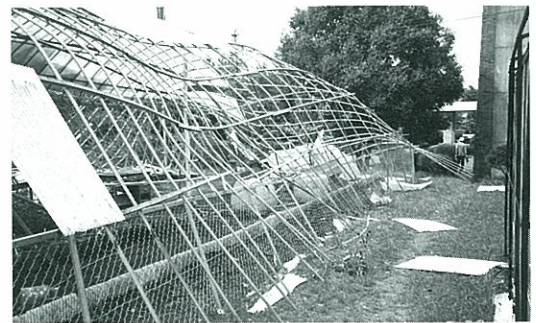
写真－3 強風で破壊された灌水制御簡易施設
