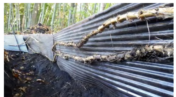
図 7-2 継ぎ目からの地下茎の侵入 (手前側を掘り起こして撮影)
