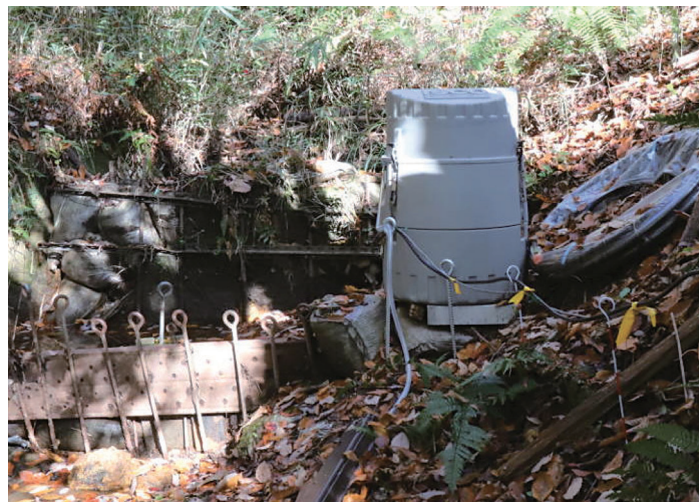
写真1 流量観測施設の近くに設置した自動採水装置（ISCO 社 6712）
