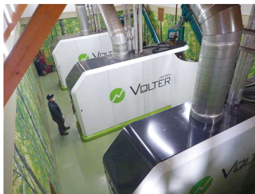
写真1 国内で稼働している小規模CHP装置の発電所
