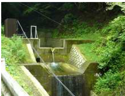
写真1 操作流域の量水堰
