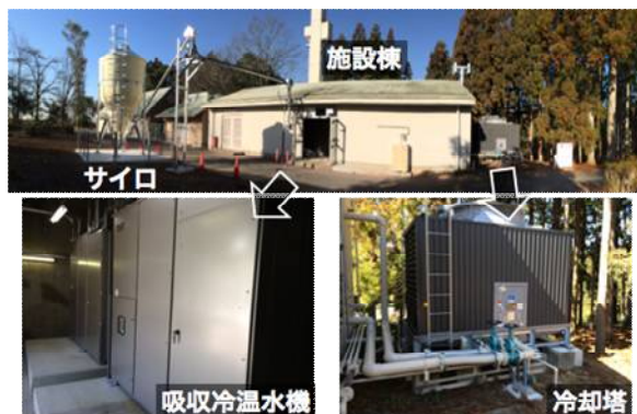
森林・林業研究センター内に設置された ペレット焚冷暖房施設
