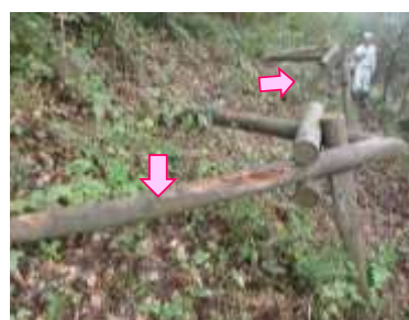
図2 木材部材の折損状況
