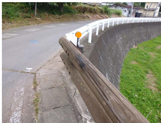
写真2 生物劣化の様子
