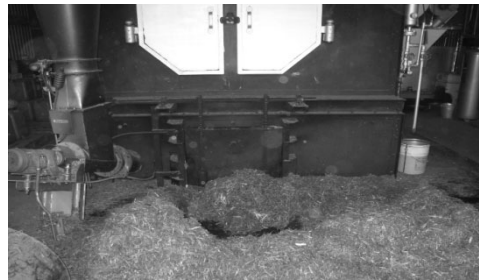
写真－木屑ボイラー（樹皮投入前）
