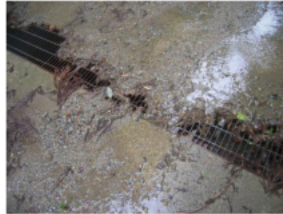
既設林道の横断溝 (土砂が堆積)
