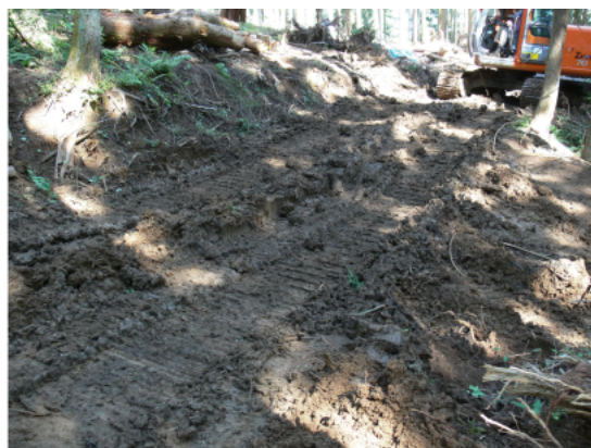
綺麗に作っても、降雨等により路面が崩れ、走行に支障を来す
