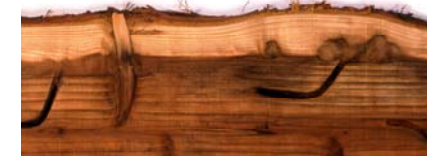
被害木の樹幹断面
