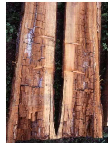
被害木内部の腐朽(縦断面)
