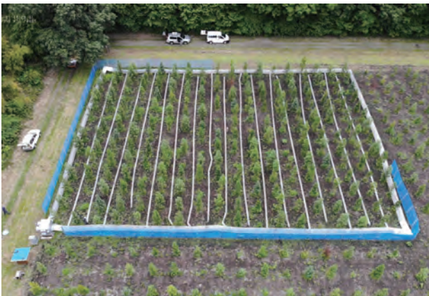
図-2 防霜ヒーターの設置状況 採種園内に列状にダクトを設置し（写真の白色部分）、防霜ヒーター（写真左下）から温風を送る。
