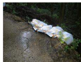
波状縦断勾配の凹部周辺の様子
