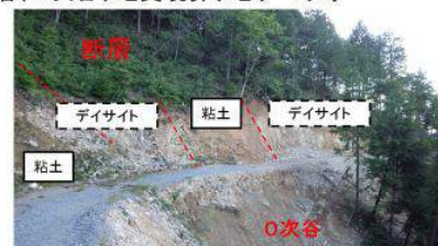
断層、0次谷を通過した箇所が発生した崩壊の例
