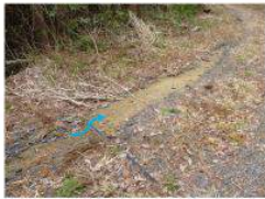
路面水がシスイエースを越流した例
