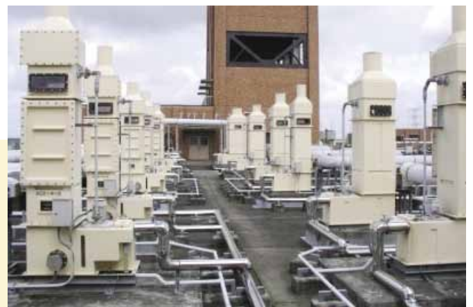
屋上に設置されたガスクラバー
