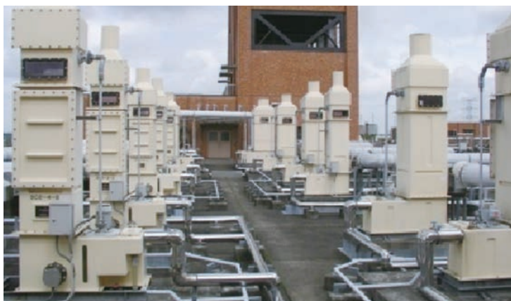
写真 2 屋上に設置されたガスクラバー
