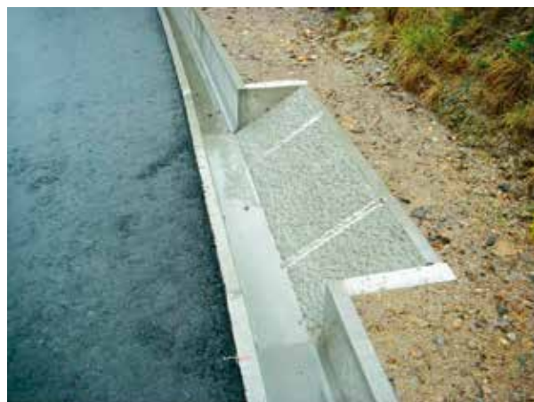
農林業用道路に設置した「はい上がり側溝」
