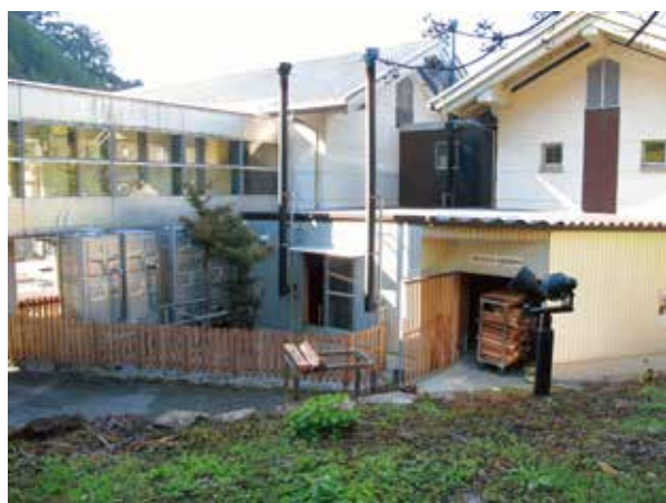
写真1 温浴施設に導入された薪ボイラー
