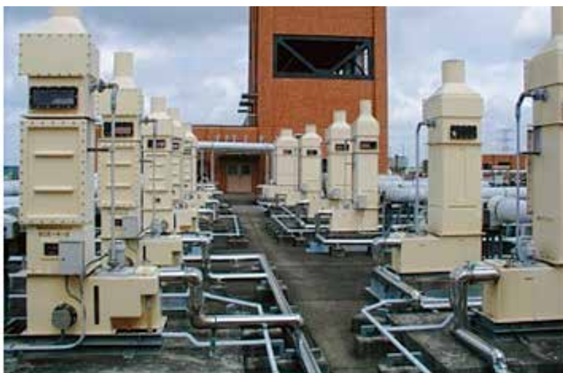
写真2 本所研究本館屋上に設置されたガスクラバー
