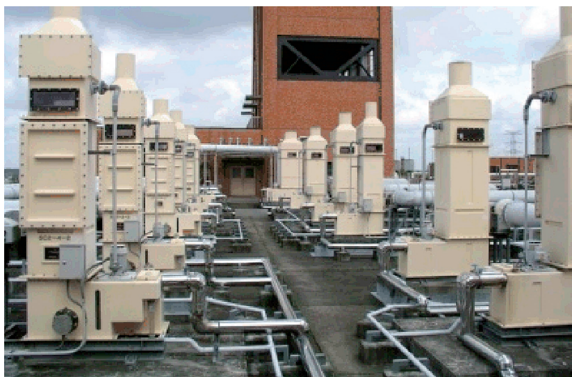
写真2 本所研究本館屋上に設置されたガススクラバー
