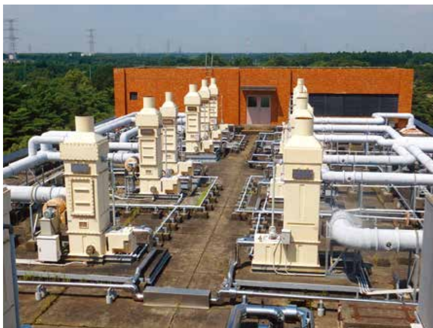
写真2 本所研究本館屋上に設置されたガススクラバー
