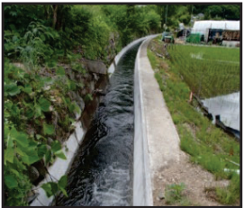
老朽化した用水路の整備・更新
