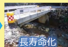
橋梁の老朽化
