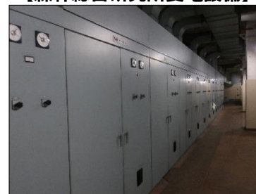
【森林総合研究所変電設備】
