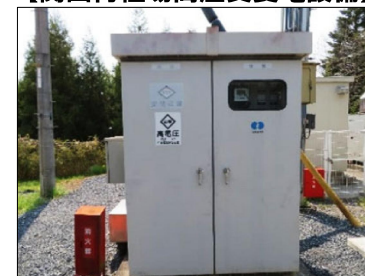
【関西育種場高圧受変電設備】
