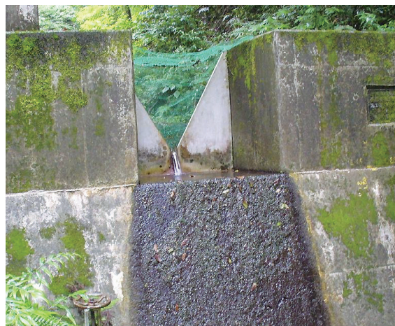
写真-2 3号沢の最下流にある量水堰
