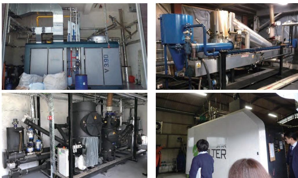
写真1 国内で導入されている小型ガス化熱電併給装置の例
