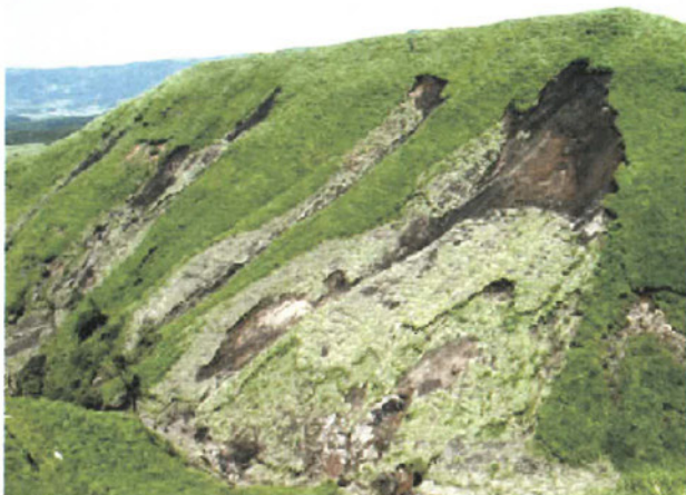
写真－1 草地斜面で発生した崩壊
