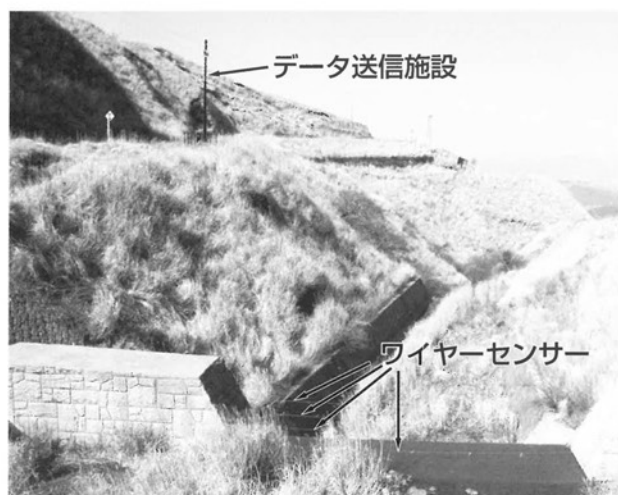
写真－1 砂防ダムに設置されているワイヤーセンサーとデータ送信施設
