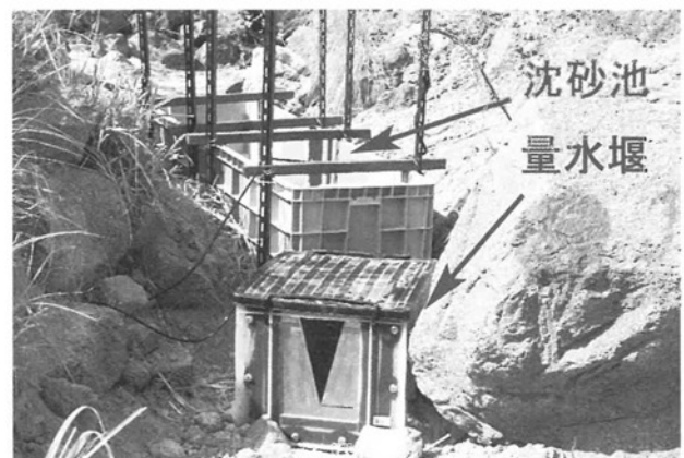
写真－1 流出量観測施設の概要
