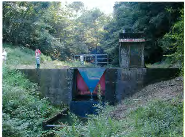
写真－1 去川森林理水試験地の量水堰堤（2号沢）
