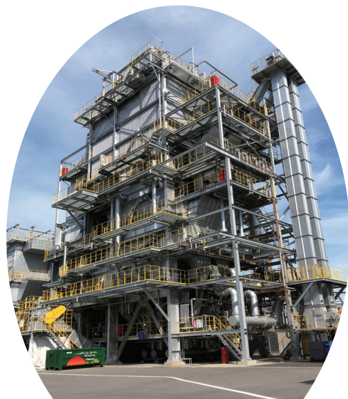
バイオマス発電所
