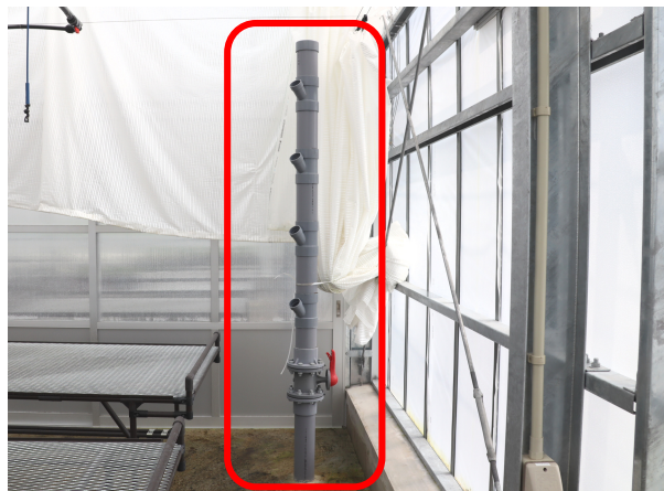
写真2 送風装置（各室の四隅にある）
