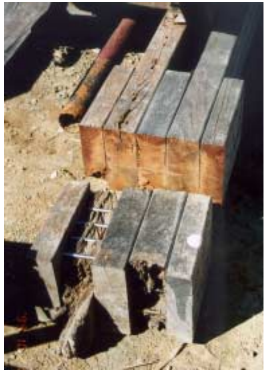
写真5 破壊起点となった下弦材接合部とその切断面
