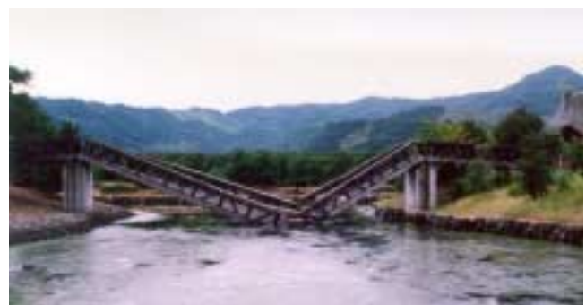
写真 1 4 号橋落下直後の様子
