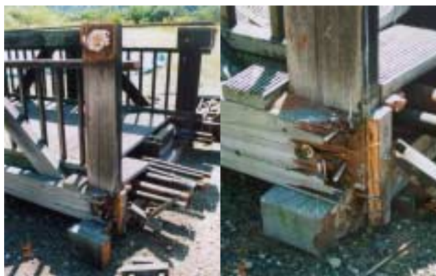
写真 2 移動した木橋落下部分とその接合部
