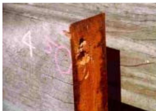
写真 3 下弦材切断面と内部腐朽の様子
