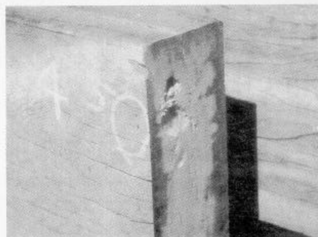
写真4 トラス下弦材の母材切断面 内部のみが腐朽している。厄介なのは内部の腐り様が 外観から推し量れないことである。宮武敦氏撮影
