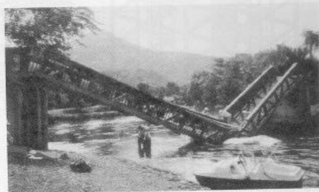
写真1 事故直後の状況 愛媛県宇和島地方局建設部撮影
