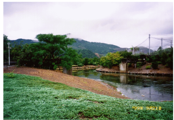
写真 1. 落橋した 4 号橋 (中央部は撤去されている)
