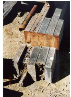
写真 4 破壊した 4 号橋 下弦材の接合部とその切断面
