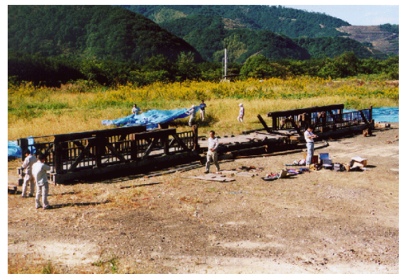
写真 2. 移動後の 4 号橋落橋部分
