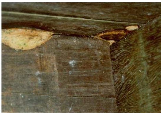
写真6 現存橋の床板下部に認められた シイサルノコシカケの子実体
