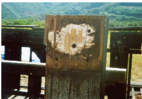
写真7 4号橋ポニートラス柱材 (上弦材との接触面が腐朽している)
