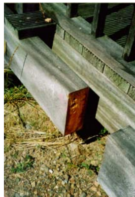
写真 3 4号橋の下弦材断面 (内部のみが腐朽している)
