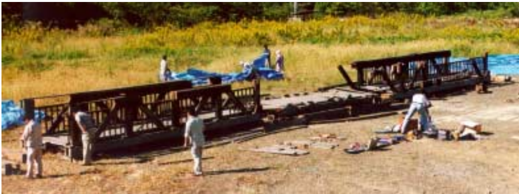
写真1 落下した4号橋 中央支間、その調査の様子
