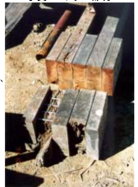
写真 2 破断した接合部
