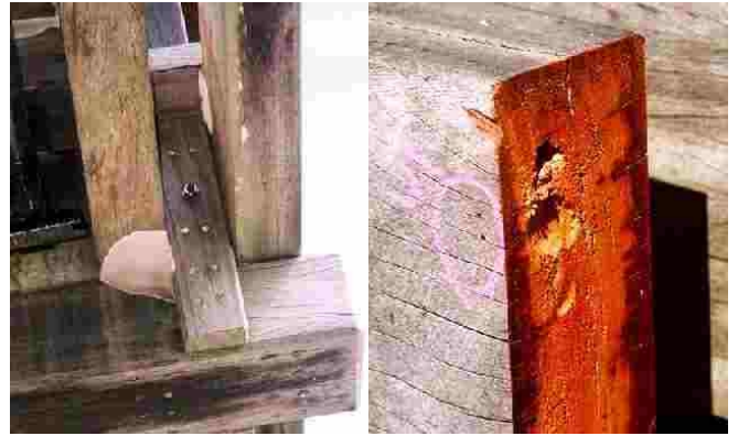
写真 2 腐朽菌の子実体と内部腐朽の様子
