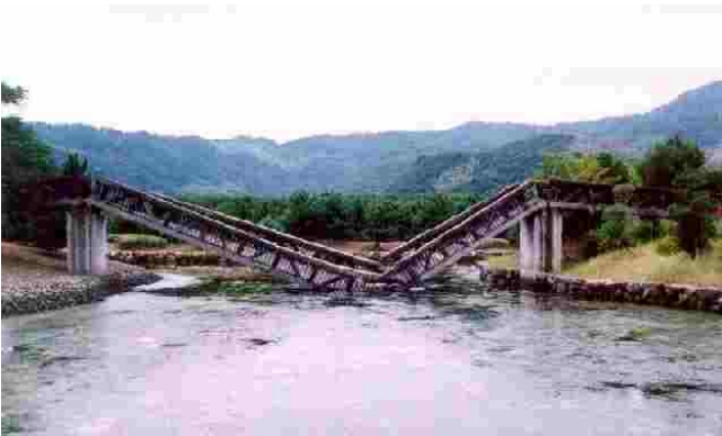
写真 1 4号橋落橋直後の状態
