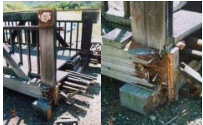
写真2 移動した木橋落下部分とその接合部
