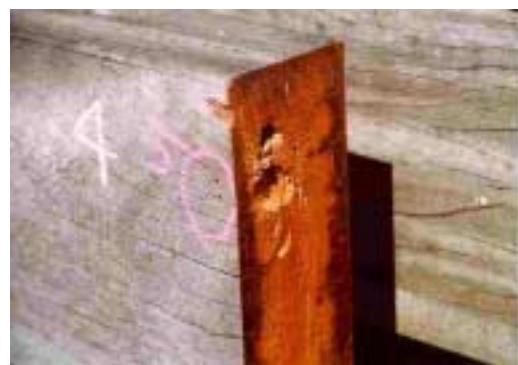
写真3 下弦材切断面と内部腐朽の様子
