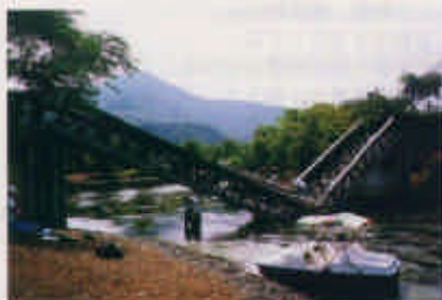
写真2. 歩道橋の落橋現場：橋長42m （写真提供：愛媛県宇和島地方局建設部建設第三課）
