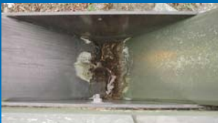
下弦材格点内部の腐朽
