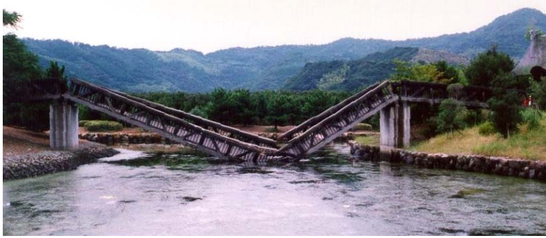
落下した公園内木橋
