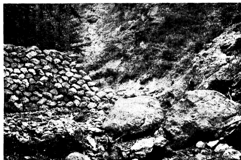
写真 36. 五開の破壊された空積堰堤
