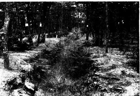
写真68. 宮城県仙台市深沼 防潮林内の排水溝。
