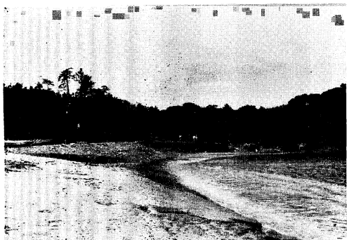
写真62. 宮城県本吉郡志津川町長清水 防潮林帯前縁護岸の欠壊。
