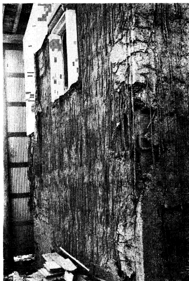
H207 土蔵壁の剥離 （村上市岩船町八日市 工藤氏宅）
