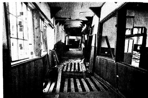
G 103 廊下の変形 (新潟市 大形小学校)
