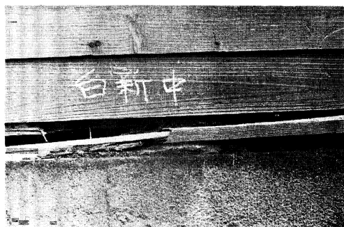
I 103 腐朽，土台 （新潟市 白新中学校）
