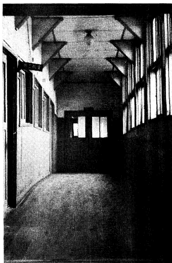
G 105 廊下の変形 (新潟県警察学校)
