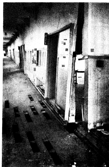
G 106 廊下の変形 (新潟市 大形小学校)
