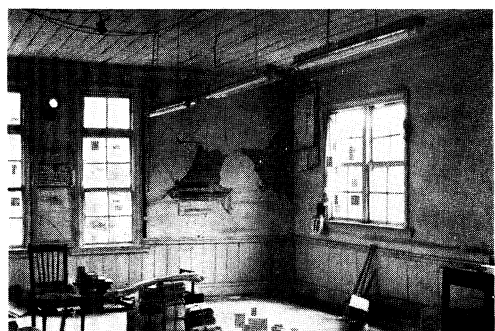
H204 漆喰壁の剥離 (新潟県岩船郡 山北村役場)
