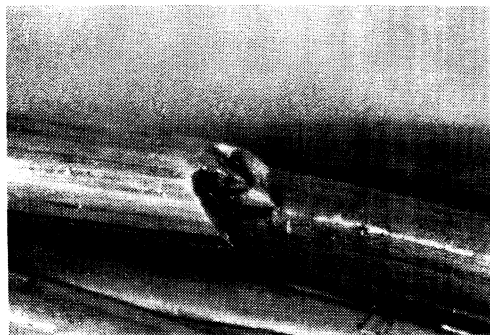
写真 7. 外部にハネ出した谷断線
