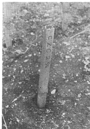
Fig. 4 CZC 処理杭の地上部木口面の腐朽
