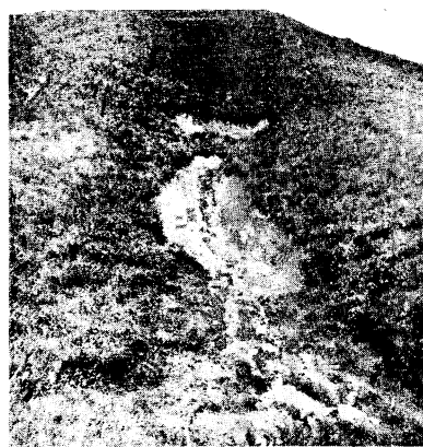
写真 16 風師山系大坪川流域の崩壊 Phot. 16 Landslides on Kazashiyama.
