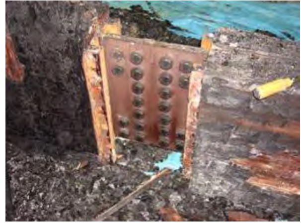
写真8 加熱後の状況 (ボルト接合部)
